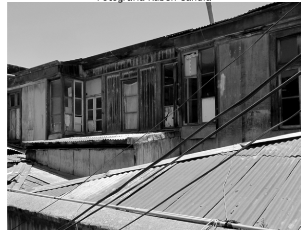
Imagen 62 | Tercer piso bloque calle Vallejos | Fotografía personal
