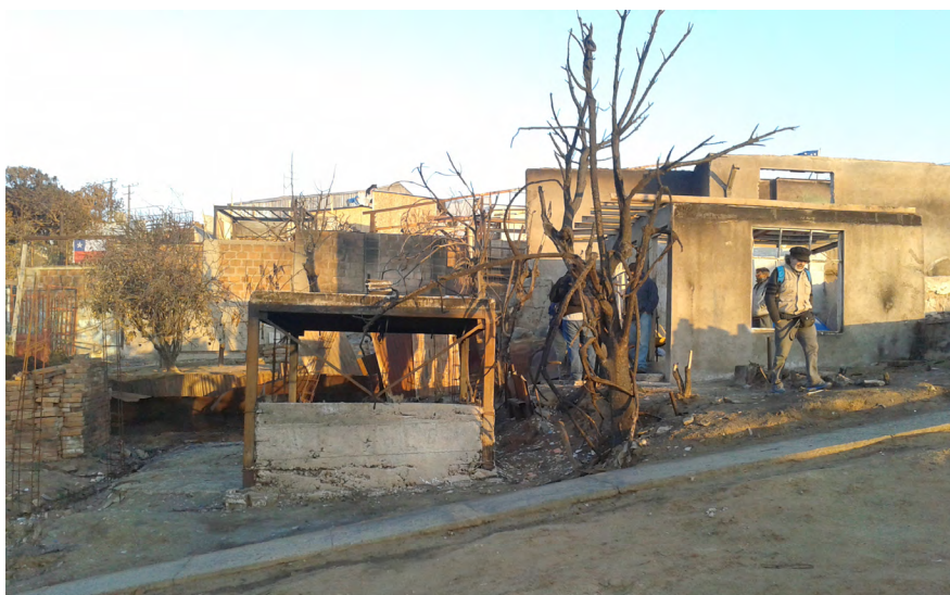
Imagen 3. Viviendas post incendio (fuente: Verónica Maturana).
