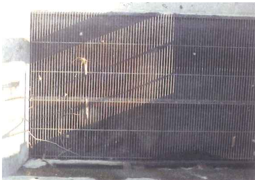
Figura 3.10: Rejillas en la toma de agua [4]
