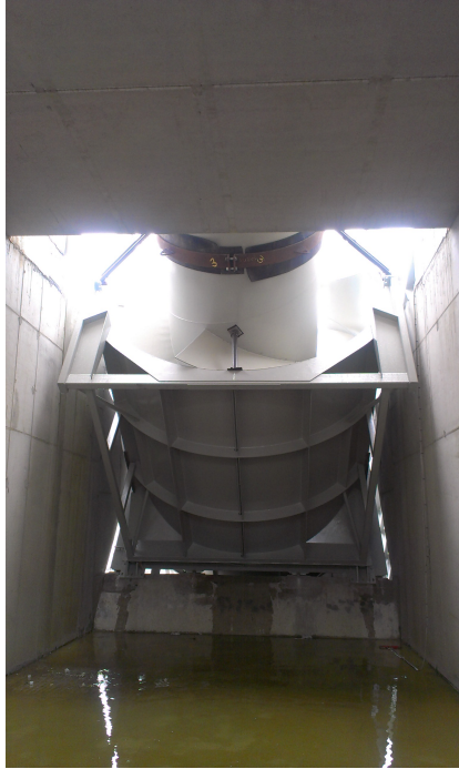
Figura 5.50: compuerta especial en la misma estructura metálica de los tornillos (foto propia)
