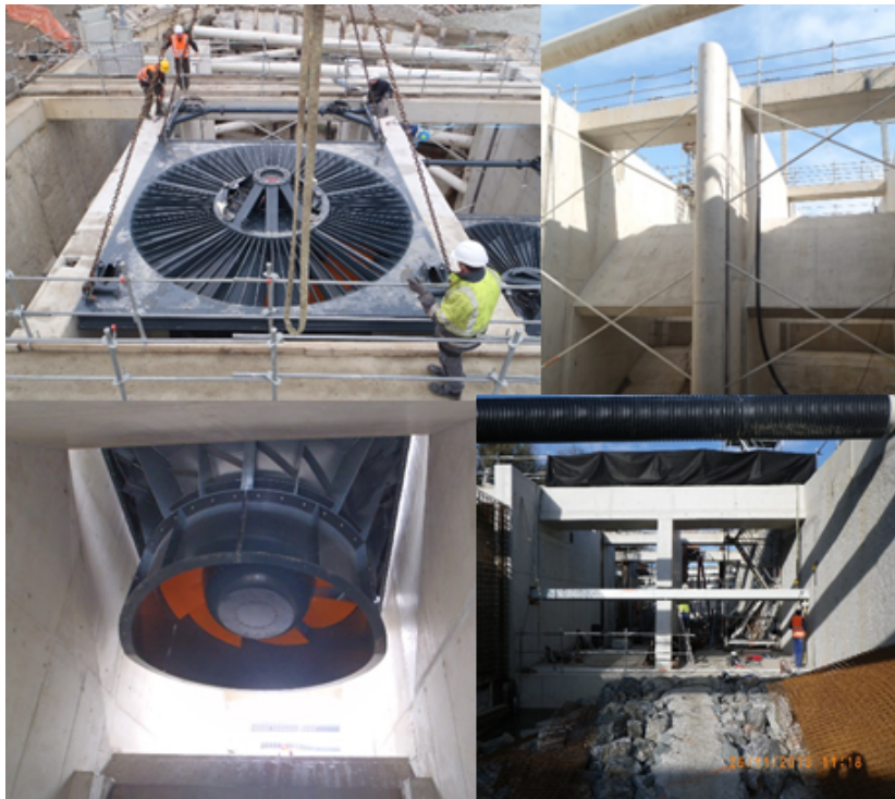
Figura 5.34: Central Cavaletalde (fotos propias)
