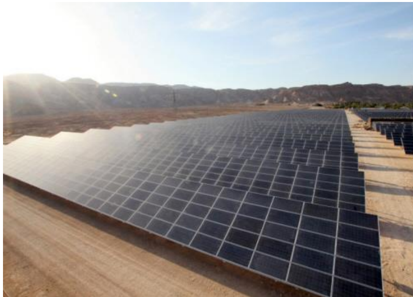
Ilustración 12 Disposición de paneles fotovoltaicos en grupo
