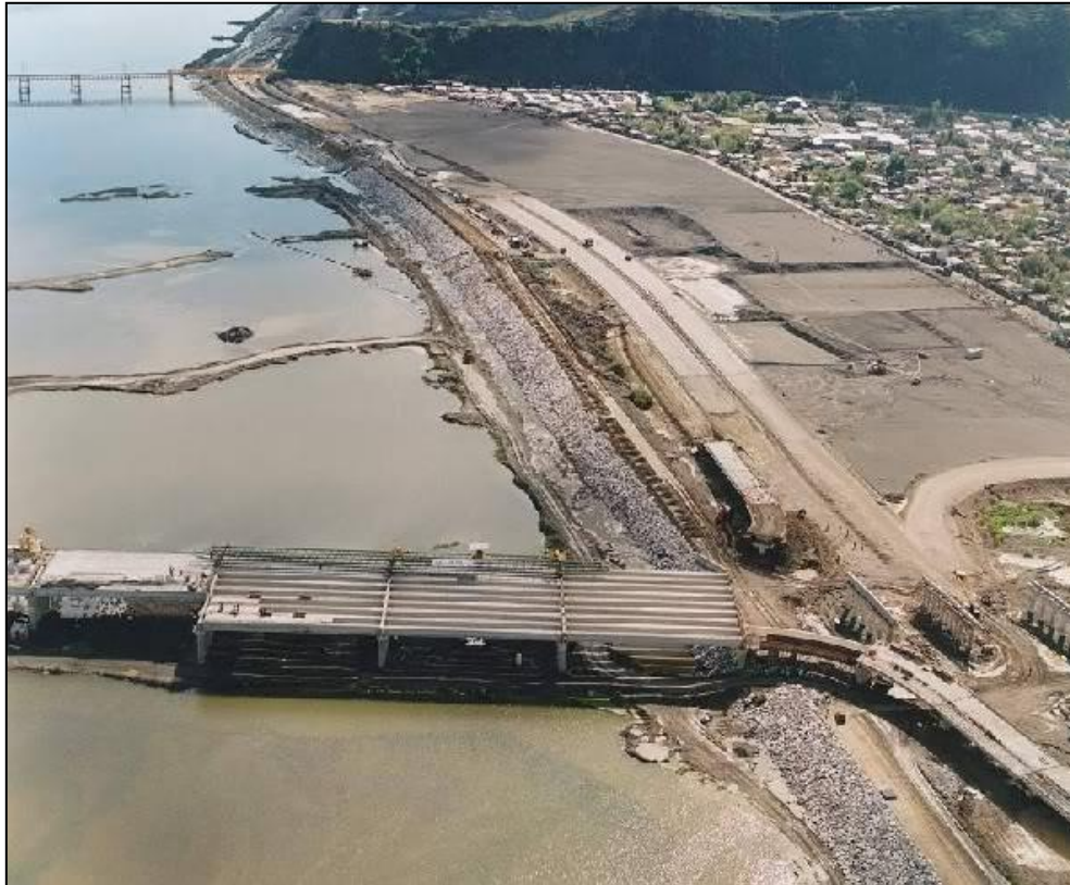
Figura 5.3: Vista de las defensas fluviales de la ribera norte del río Biobío, hacia aguas abajo del puente Llacolén. Fotografía tomada en el año 2000, durante la construcción del puente Llacolén.
