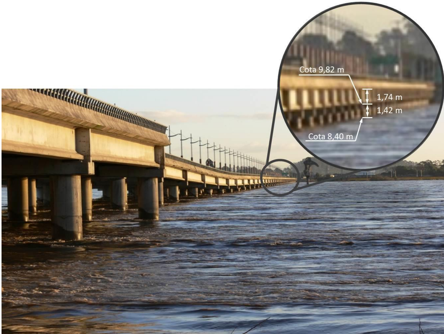
Figura 5.22: Vista del puente Llacolén, desde la ribera norte del río Biobío. Estimación de la cota que alcanzó el agua el día 12 de julio de 2006 a las 17:20 horas, momento aproximado en que fue tomada la fotografía.
