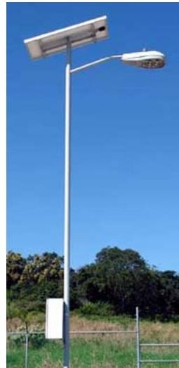
Imagen 115: Luminaria funcionando con panel solar. Fuente: www.antsolar.cl/solar-fotovoltaico/
