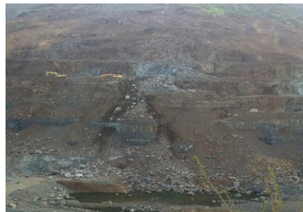
Ilustración 2: Colapso de Bancos.
