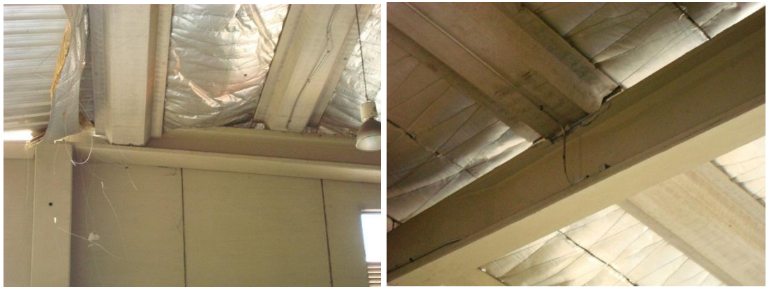
Daño en la unión de costaneras (dallas) a vigas.
