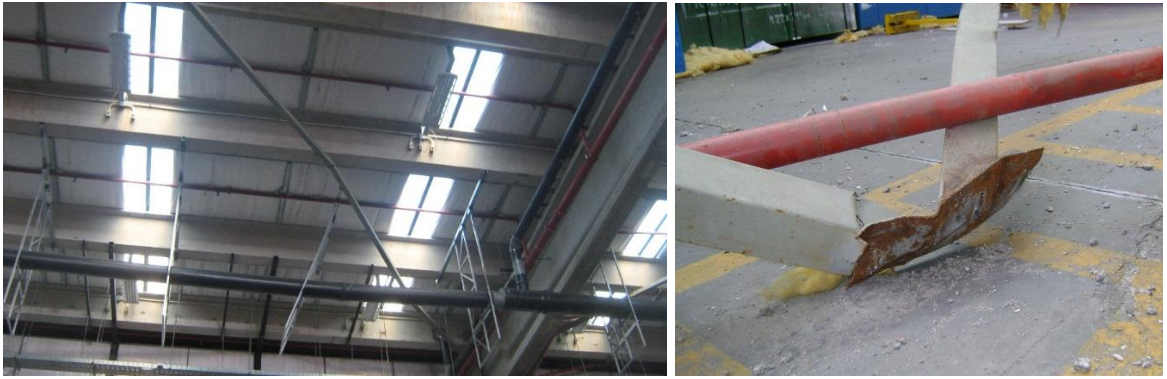
Pandeo y caída de arriostramientos de techo.
