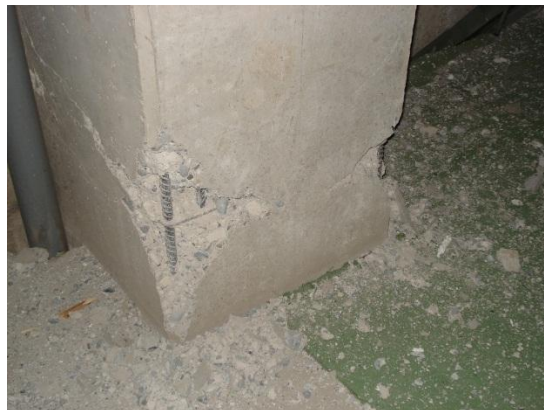
Colapso en la base del pilar.
