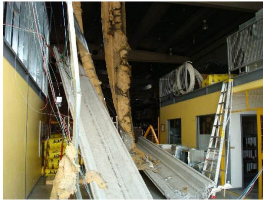
Colapso de dallas.
