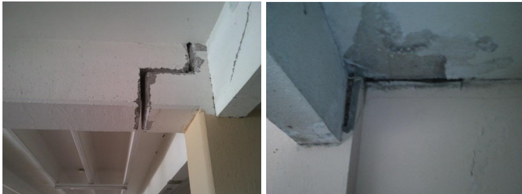
Daños conexión pilar – viga de entrepisos.
