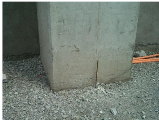
Fisuración en la base del pilar
