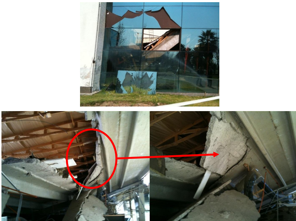
Figura V-21: Colapso de losas, se indica sobre losa separada de losas prefabricadas.
