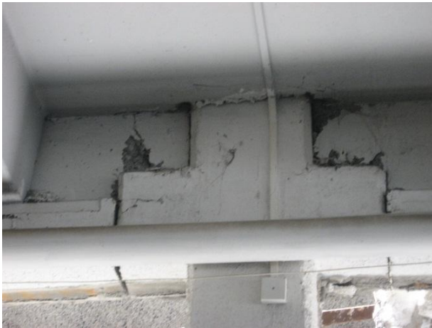
Daños en la conexión pilar – viga
