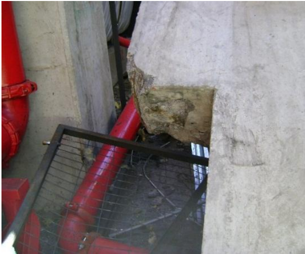
Figura V-5 : Rotura de la cabeza de la viga en la zona de falla.
