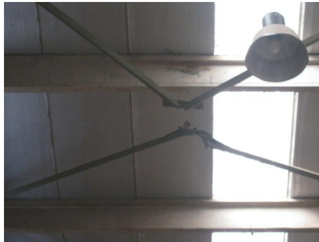
Desprendimiento de arriostamientos de techo de acero en la conexión a la viga
