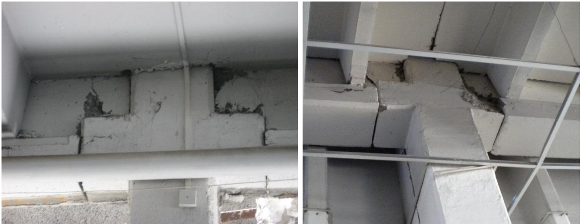
Figura VI-32: Daños en la conexión pilar – viga. Caso 3.
