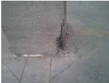
Daño en columna.
