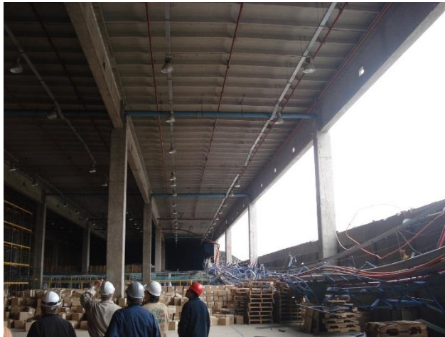
Vista interior, desprendimiento de paneles de fachada
