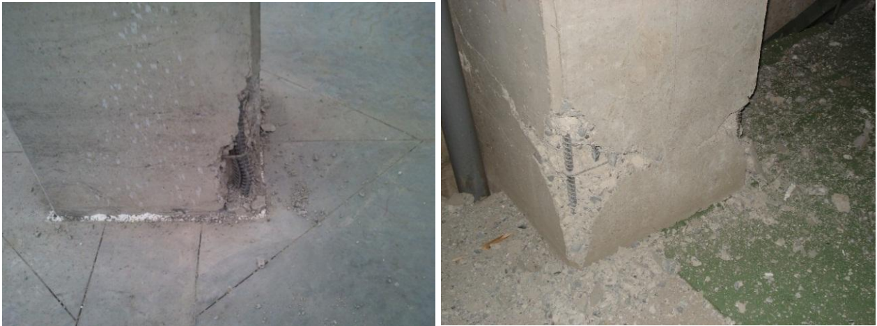
Figura V-1: Desprendimiento del recubrimiento de hormigón en la base de las columnas.
