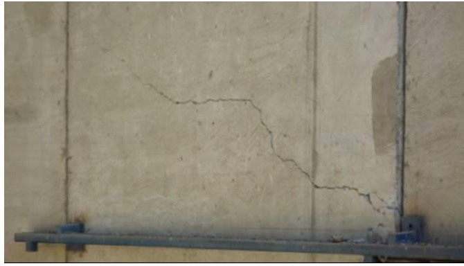
Fisura de corte en pilar de Galpón de 2100 m2.
