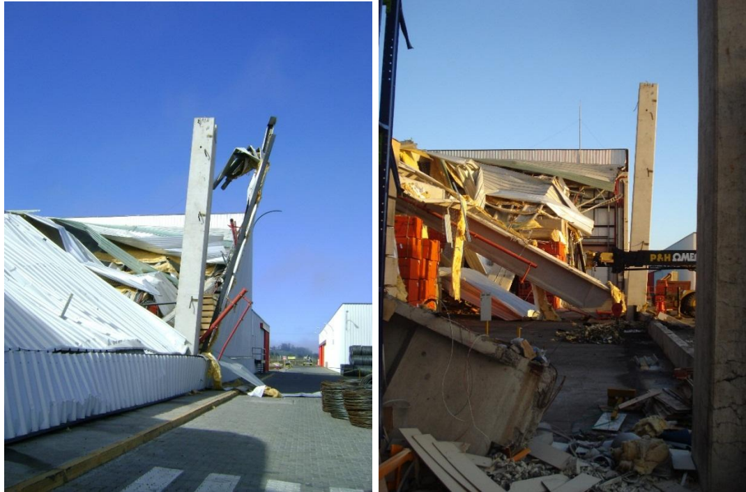
Caida de vigas por falla en la conexión al pilar.
