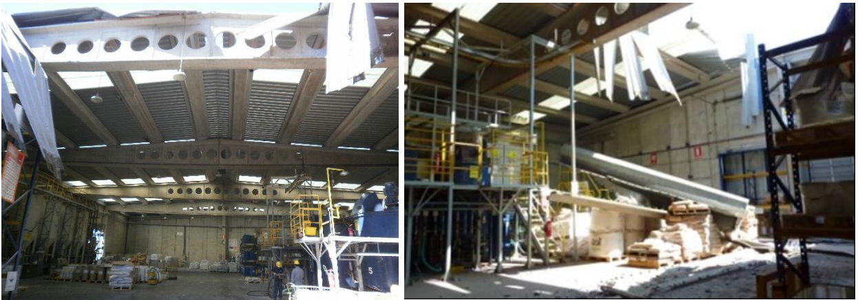
Colapso de las costaneras (Dallas) en el Galpón de 2100 m 2 .
