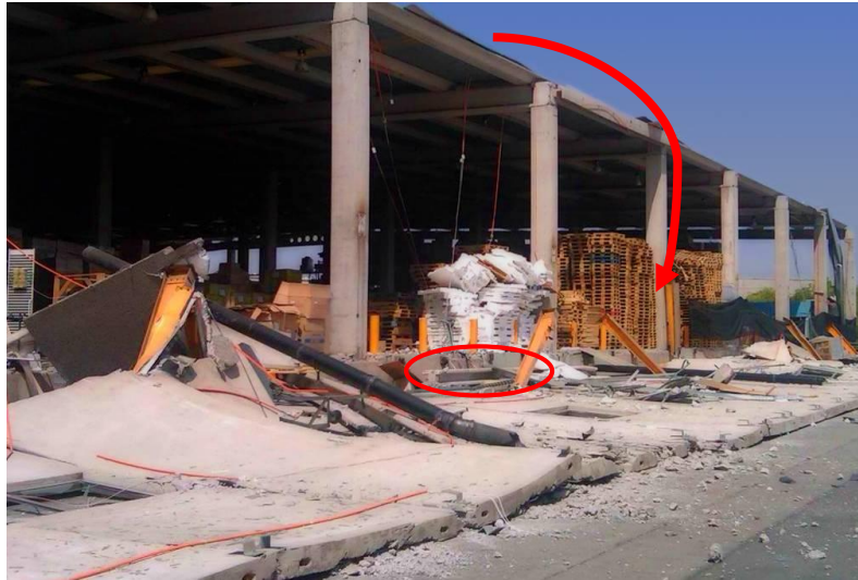
Figura V-35: Caída de paneles que arrastraron a las vigas a las cuales estaban anclados.
