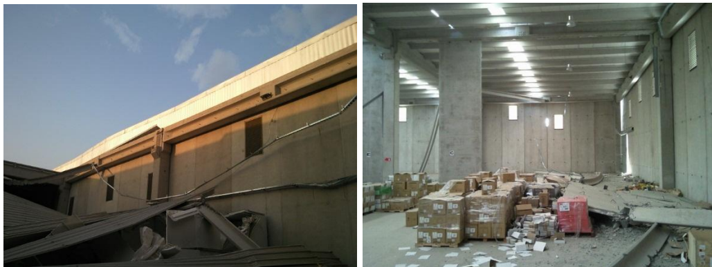
Colapso de viga de techo.
