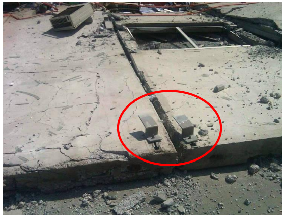
Figura V-36: Paneles colapsados con sus anclajes en buen estado.
