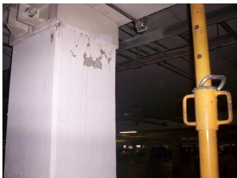
Fisuración de pilar en la parte superior
