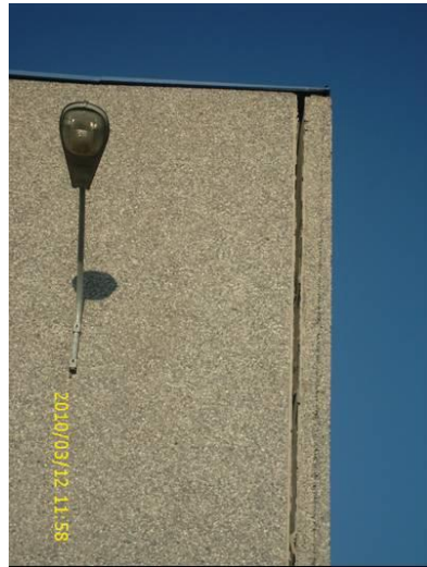
Desprendimiento de paneles de cerramiento
