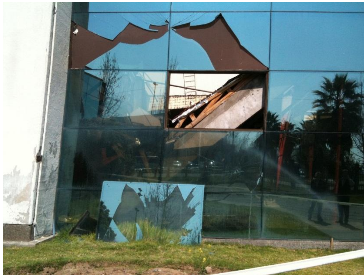
Colapso de losas prefabricadas, sobre losa despegada de la superficie causó que no trabajara como diafragma rígido.
