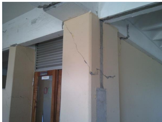
Fisuración en pilar
