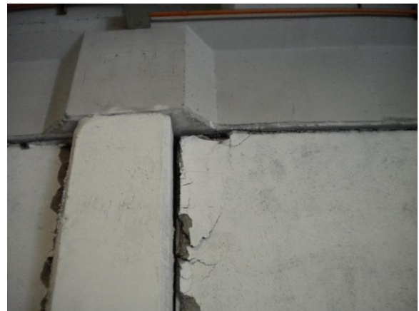
Daño en la unión entre el pilar y el muro
