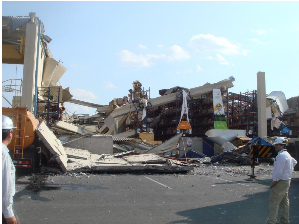
Colapso de paneles de cierre.
