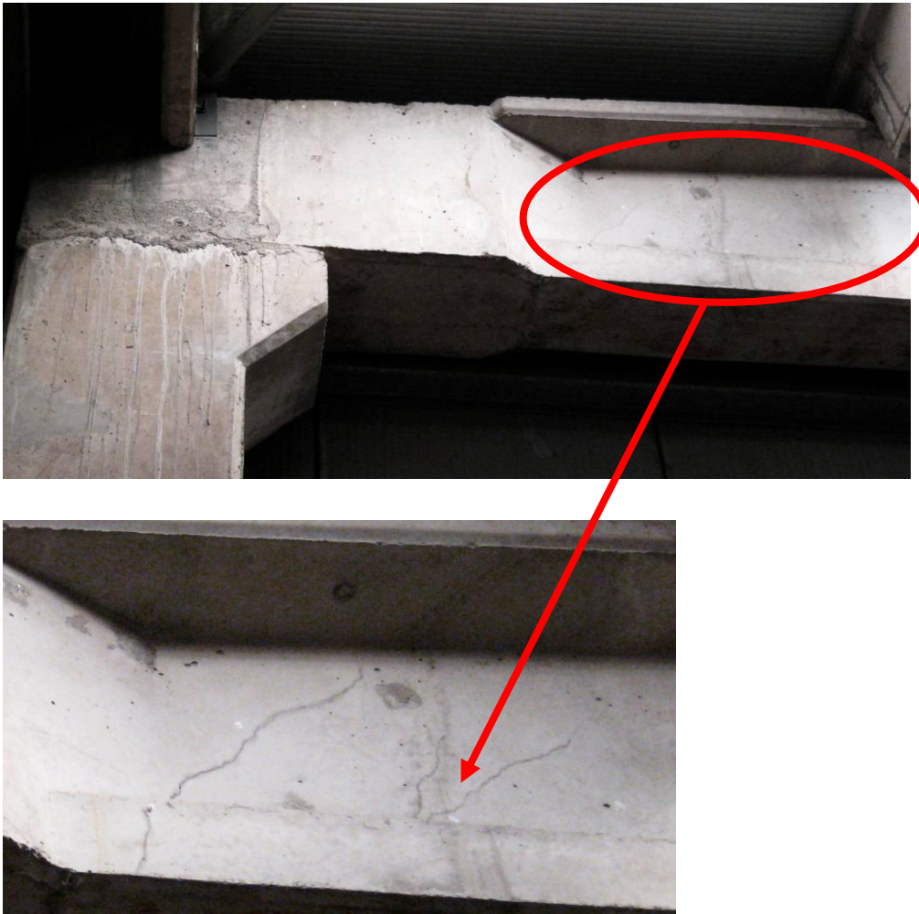
Figura V-20: Grietas de corte en viga prefabricada, adyacentes a unión húmeda al pilar.
