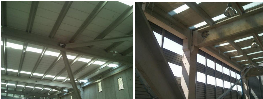
Figura V-26: Desprendimiento de hormigón y fallo de conexión de riostras de hormigón a vigas de techo.
