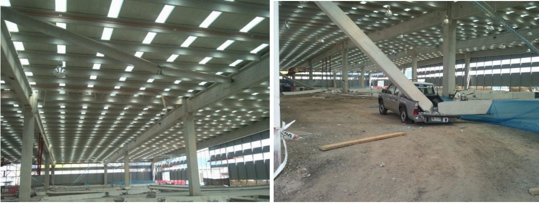
Arriostramientos de techo dañados y colapsados.
