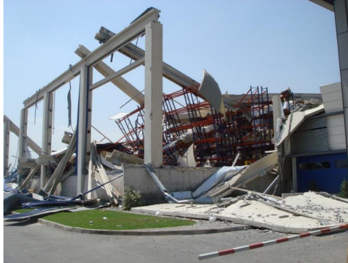
Figura V-24: Volcamiento y caída de vigas secundarias tipo Tau.
