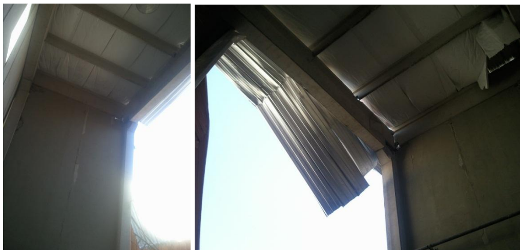
Daños leves en paneles de fachada
