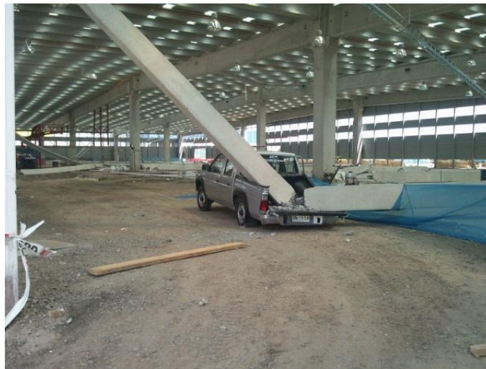
Figura V-27: Daños severo producto de la caída de arriostramientos de techo.
