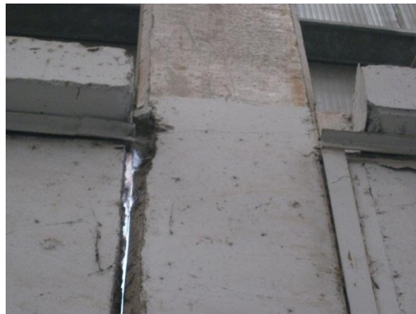
Daño en el pilar por golpes con la estructura.
