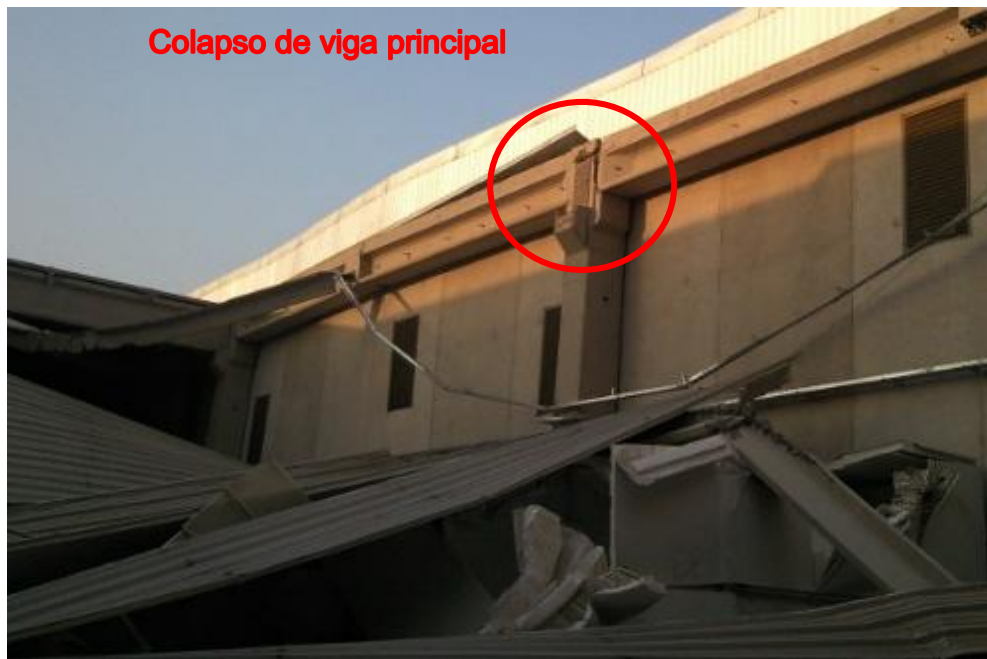
Figura V-19: Viga principal cae.
