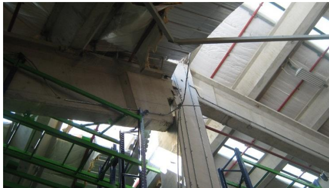
Destrucción de apoyo en consola de viga a pilar.
