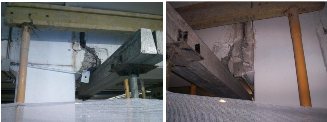
Daños en conexión húmeda pilar - viga
