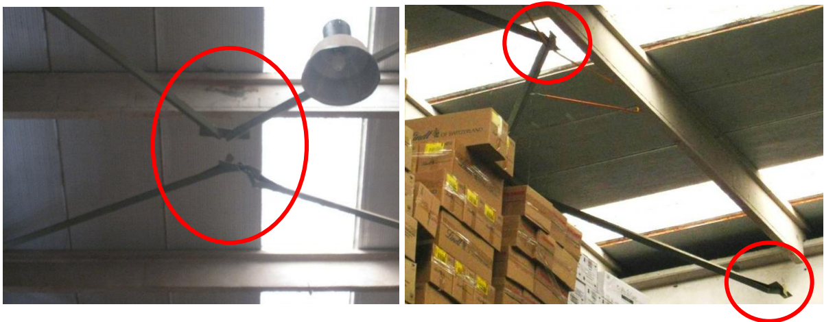
Figura V-29: Fallas de conexiones por soldadura in situ y perfiles sub dimensionados.
