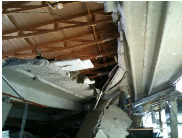
Losas prefabricadas colapsadas.
