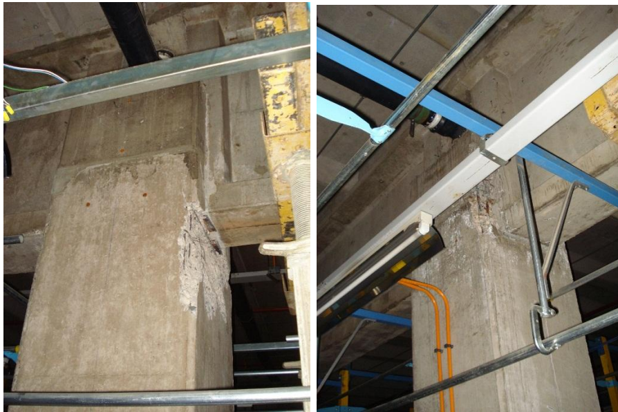
Daños en conexión húmeda entre viga y pilar
