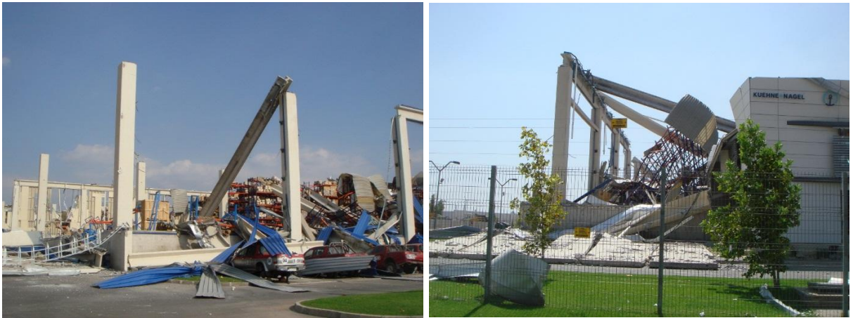
Caída de vigas, destrucción de conexión al pilar. Colapso de conexión entre vigas.
