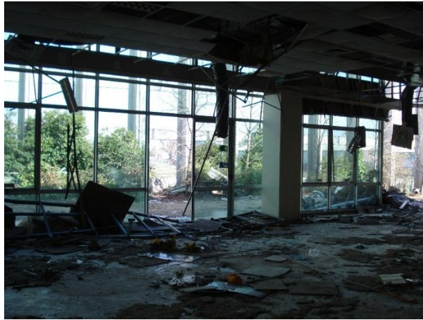
Daños severos en elementos no estructurales.
