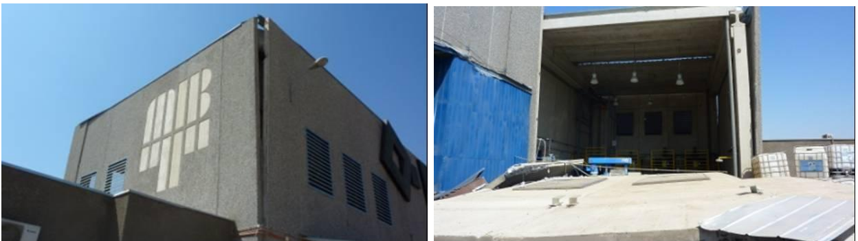
Paneles desprendidos y caídos.
