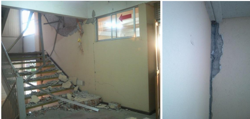
Daños en muros sismo resistentes construidos en sitio
