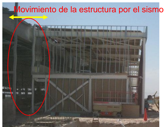
Figura VI-22: Daños en edificio de oficinas por choque con galpón, separación de 25 cm.
