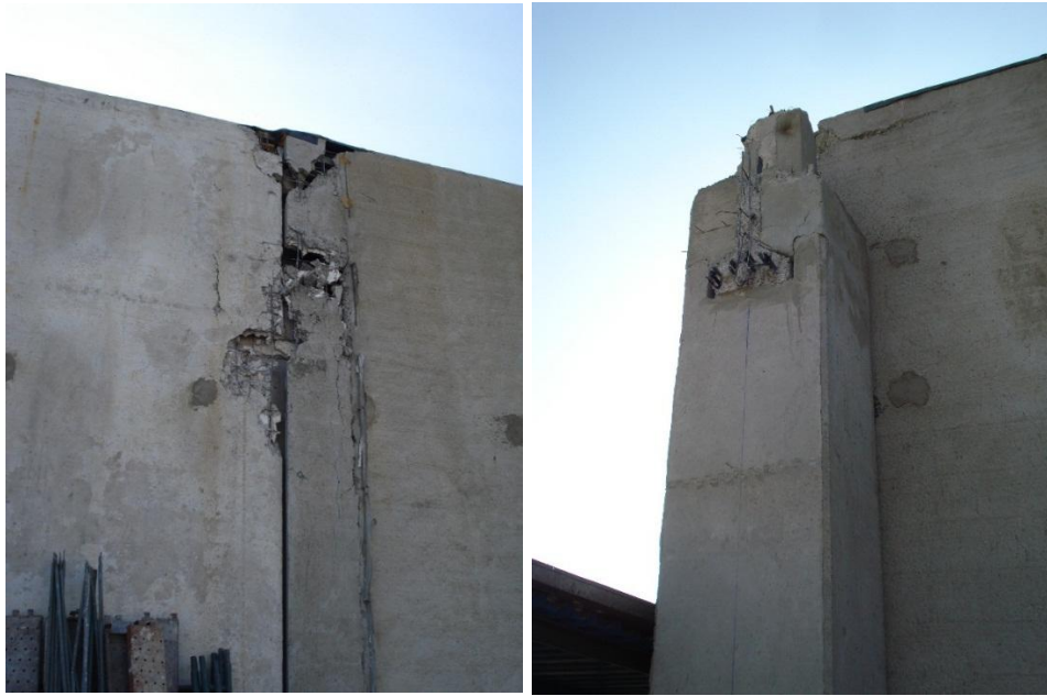
Daño por golpe entre muros y colapso de viga
