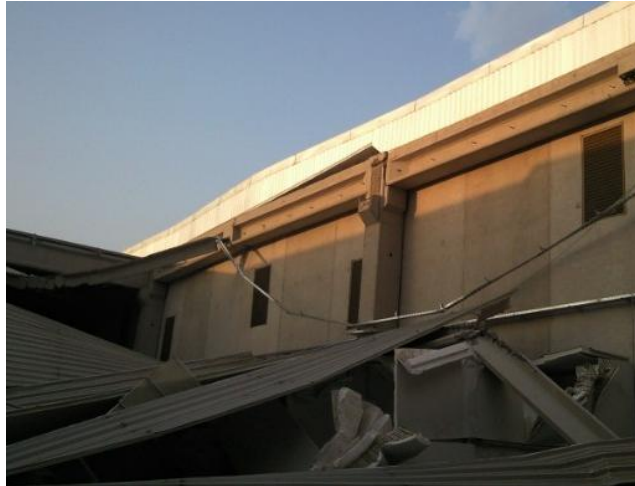
Figura VI-7: Daño severo por desplome de viga en conexión a pilar (Indicación 1, Figura VI-3).
