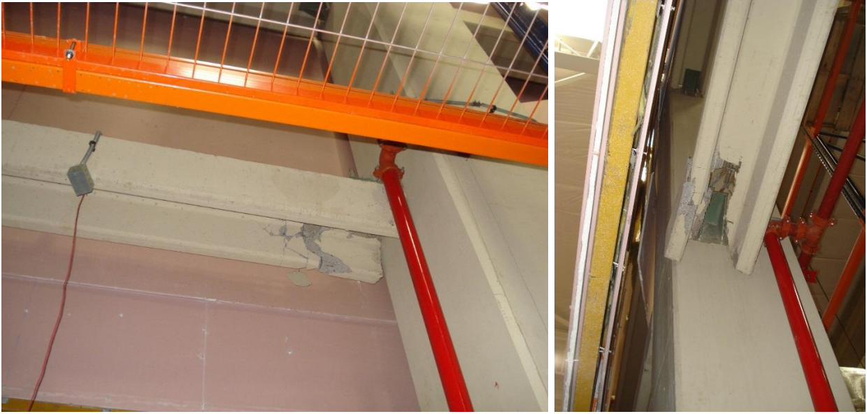
Dstrucción de la conexión viga – pilar.
