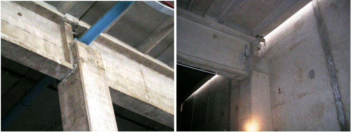
Daños en las conexiones de la viga al pilar.
