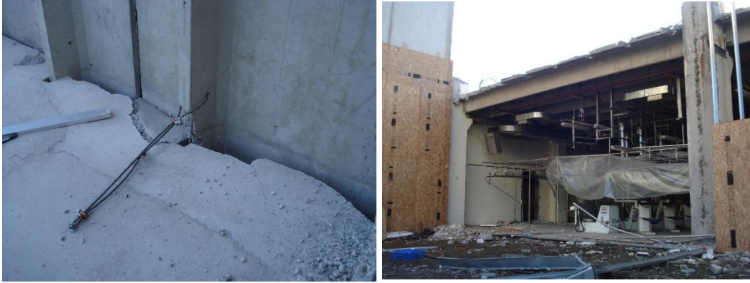
Daño y colapso de paneles de cierre.
