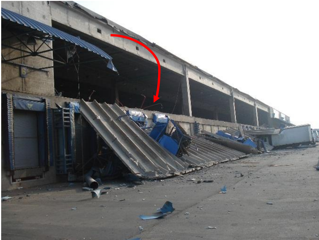
Figura V-34: Caída de paneles por fallo de la conexión.
