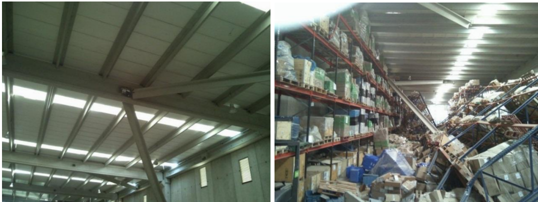
Caída de arriostramientos de techo.
