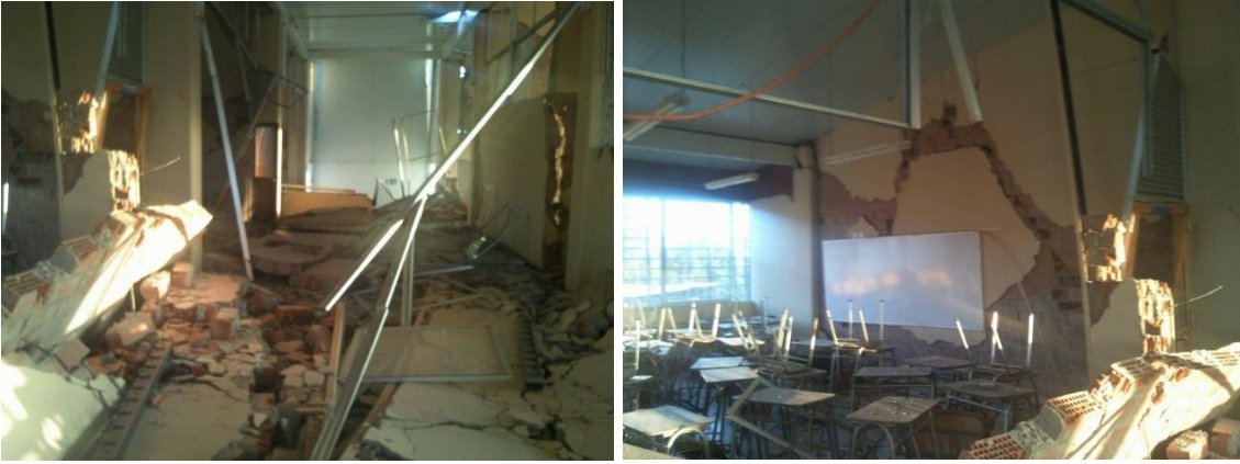
Albañilerías no estructurales colapsadas
