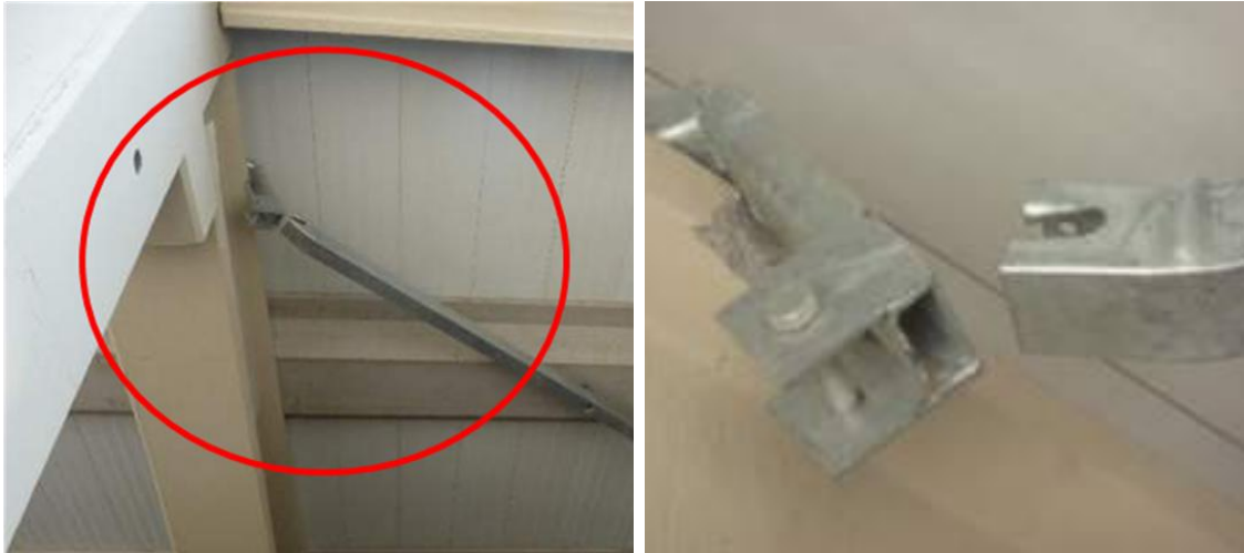
Figura V-28: Falla en conexión de arriostramiento de perfiles tubulares.
