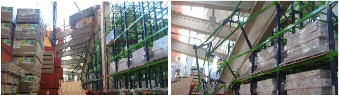
Desplome de vigas de techo arrastraron a costaneras.
