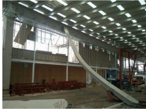
Figura VI-21: Caída de arriostramientos de techo
