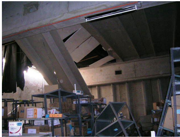
Colapso de losetas prefabricadas.
