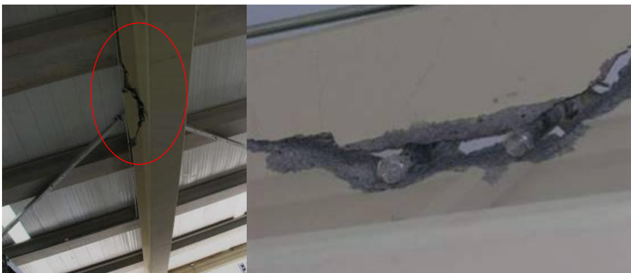
Figura V-30: Desprendimiento del anclaje por ejecución en zona no confinada de la viga.
