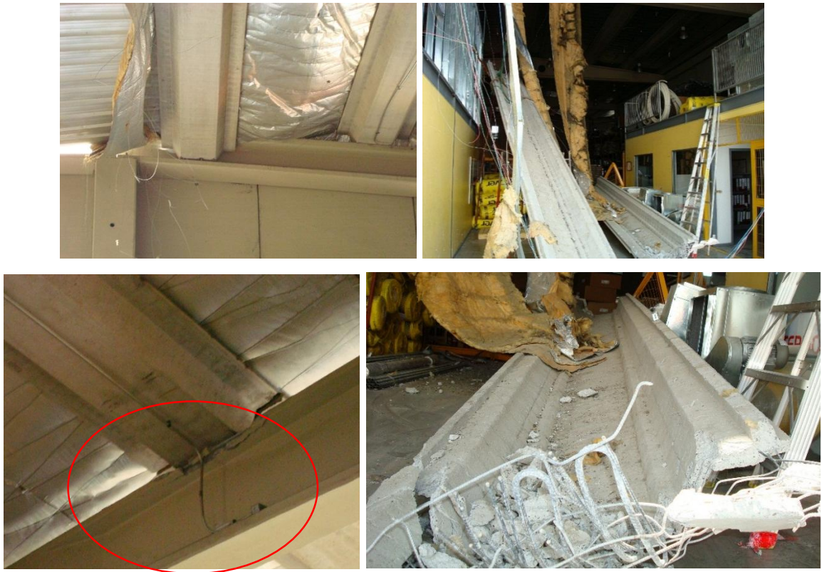
Figura V-22: Caída de costaneras (dallas) por falla en conexión a vigas de techo.
