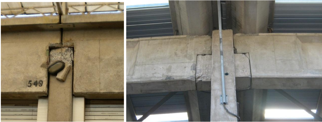
Figura V-2: Daños en conexión rotulada pilar – viga.
