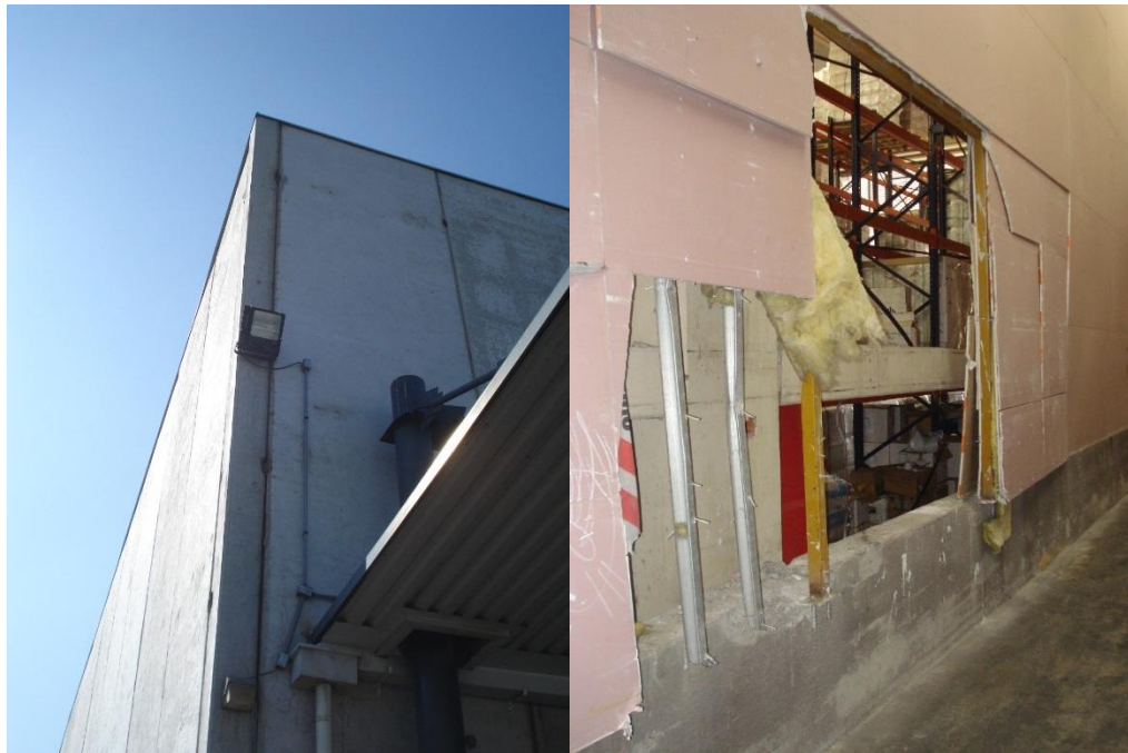
Daños en cerramiento exterior y destrucción de tabiquerías interiores.
