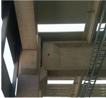
Figura VI-20: Daño en conexión húmeda entre viga y pilar.
