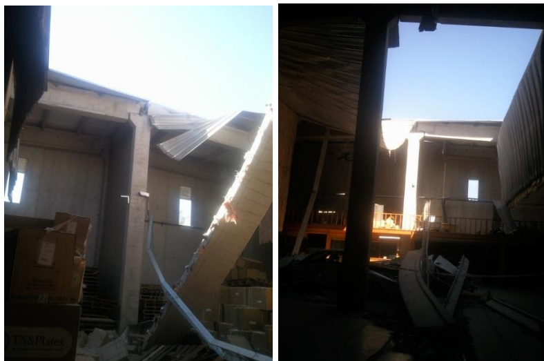
Colapso de viga de techo.
