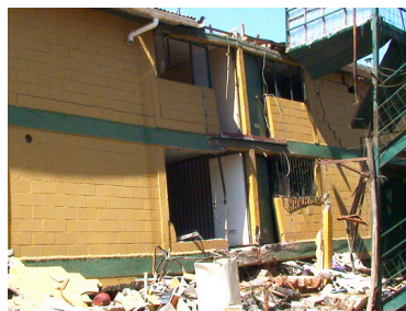
Derumbie de c+Conjunto Vivienda Social. PANAHUE
