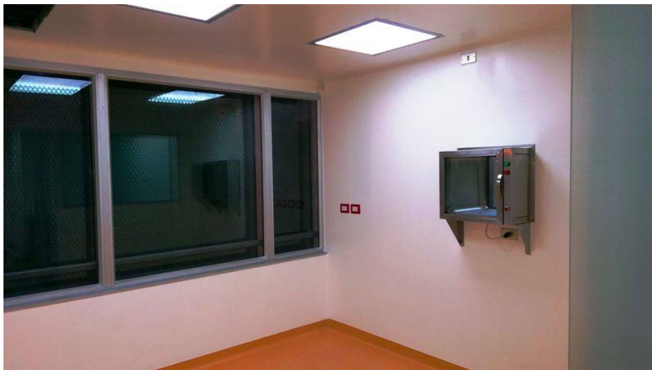
Figura 10. Vista interior del Pabellón de Cirugía Menor. Se alcanza a visualizar el piso especializado para áreas limpias, y el pass-through farmacéutico que conecta con la sala de Purificación y Cultivo Celular.
