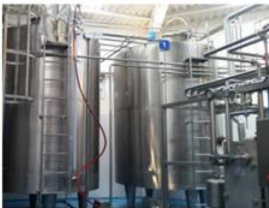
Ilustración XXIX Tanques de almacenamiento en frío 48
