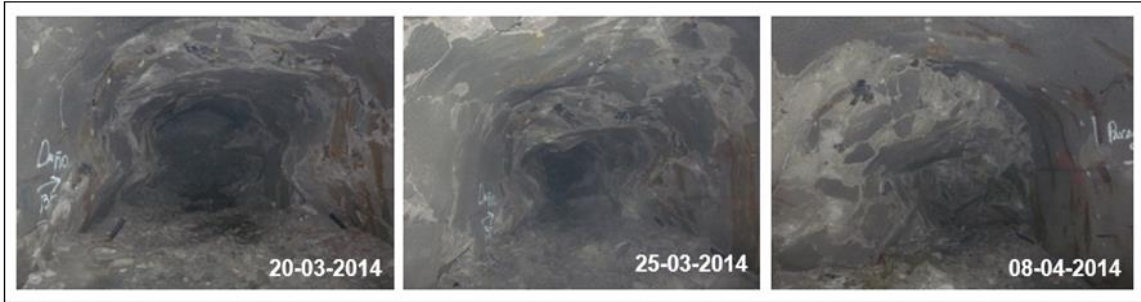
Ilustración 41. Evolución de los daños geomecánicos en C14 UCL (Superintendencia Mina Norte (b) 2014).
