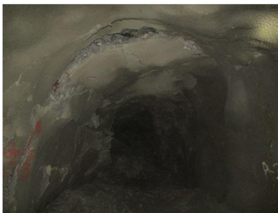
Ilustración 36. Daño C12 UCL (Superintendencia Mina Norte (b), 2014).
