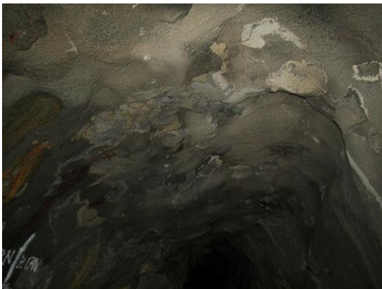
Ilustración 35. Daño C11 UCL (Superintendencia Mina Norte (b), 2014).
