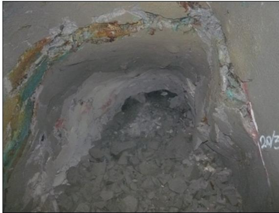
Ilustración 32. Daño C10 UCL (Superintendencia Mina Norte (b), 2014)
