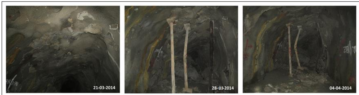
Ilustración 43. Evolución de los daños geomecánicos en C11 UCL (Superintendencia Mina Norte (b) 2014).
