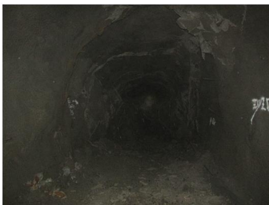
Ilustración 37. Daño C13 UCL (Superintendencia Mina Norte (b), 2014)
