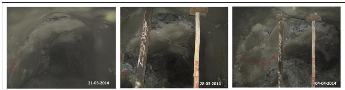
Ilustración 44. Evolución de los daños geomecánicos en C12 UCL (Superintendencia Mina Norte (b) 2014).
