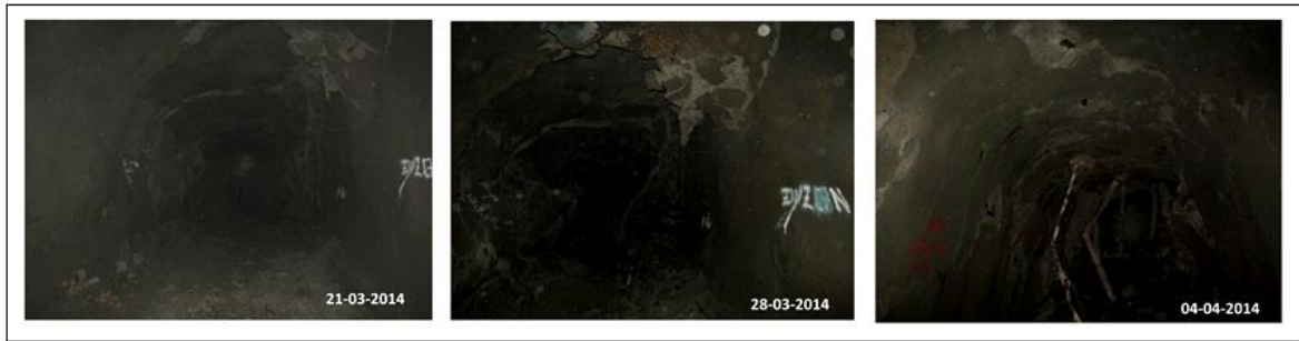
Ilustración 45. Evolución de los daños geomecánicos en C13 UCL (Superintendencia Mina Norte (b) 2014).
