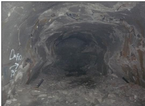
Ilustración 33. Daño C14 UCL (Superintendencia Mina Norte (b), 2014).
