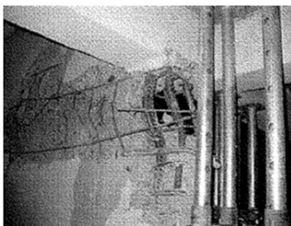
Figura 2.1. Fotografía de inspección en fallas en muro Q. (Fuente: Kozmidis et al., 2014)
