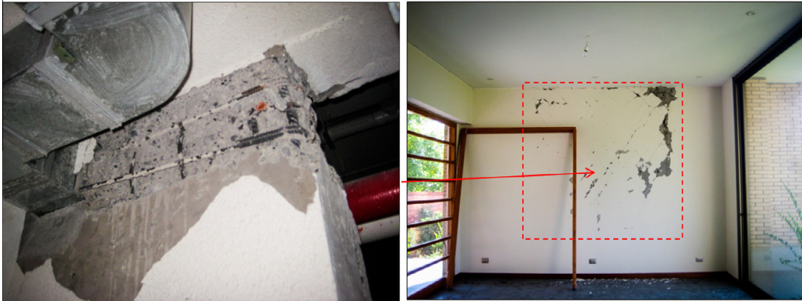
Figura 2.4. Fallas en edificio dañado durante Terremoto de 2010 (Fuente: Lemnitzer et al., 2014).
