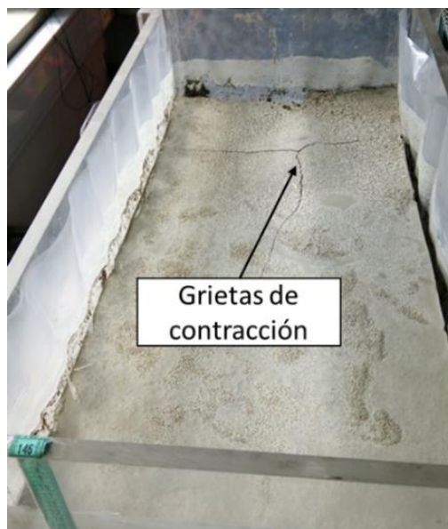
Figura 3.17. Grietas de contracción después de 19 días.
