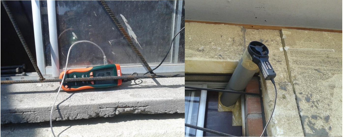
Figura 15. Instalación adquisición de datos anemómetro.
