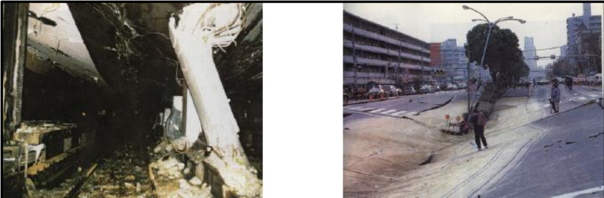
Figura 1-3: A la izquierda, el daño sufrido por la estación de metro Daikai luego del sismo de 1995, a la derecha, la subsidencia del terreno sobre la estación de metro Daikai (Liu, 2008)
