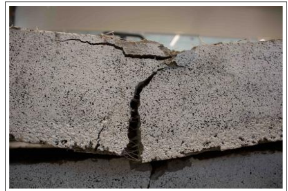
(d) Grieta horizontal cerca de la zona comprimida.
