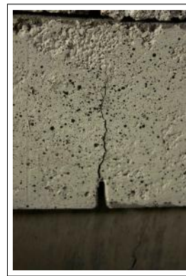
(b) Agrietamiento para fibras de acero.
