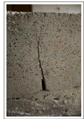
(c) Agrietamiento para fibras de polipropileno.
