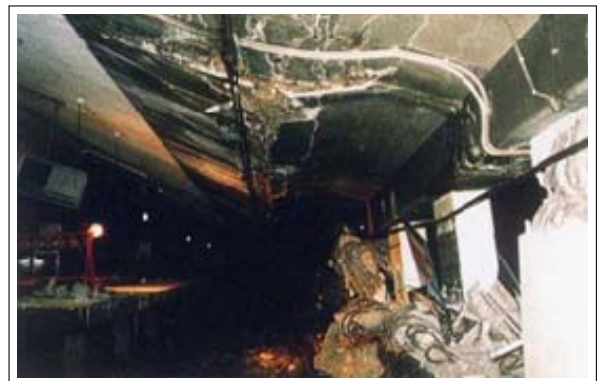
(b) Falla de columna central.
