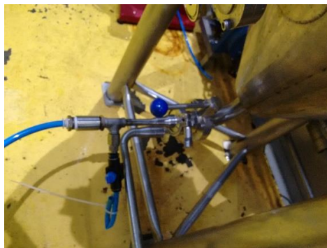
Figura 15: Adaptador para el ingreso de gas al gasificador.
