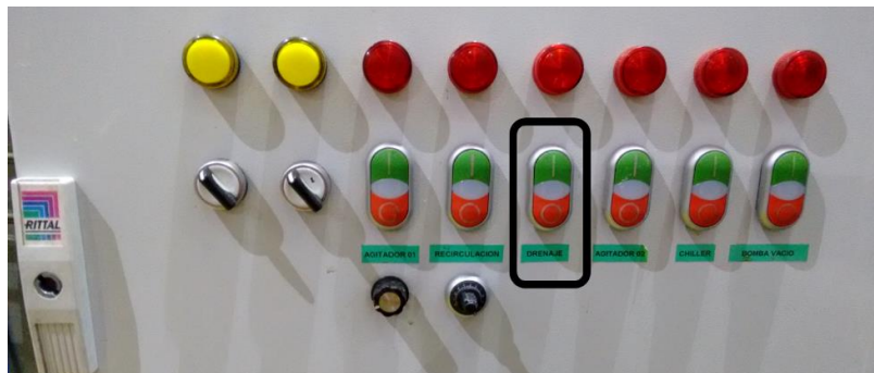
Figura 11: Interruptor de la bomba de drenaje de la planta piloto.
