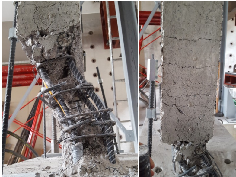
Figura 0.25: Pandeo fuera del plano, una vez finalizado el ensayo MR1.
