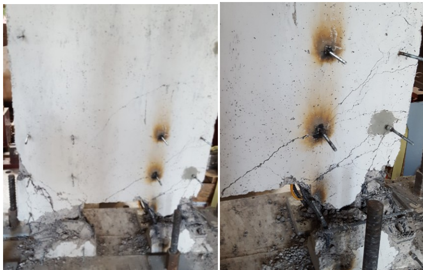
Figura 0.28: Grietas y pandeo armaduras MR2.
