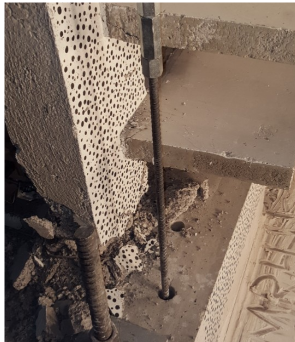
Figura 0.35: Pandeo y desprendimiento de hormigón en la falla.
