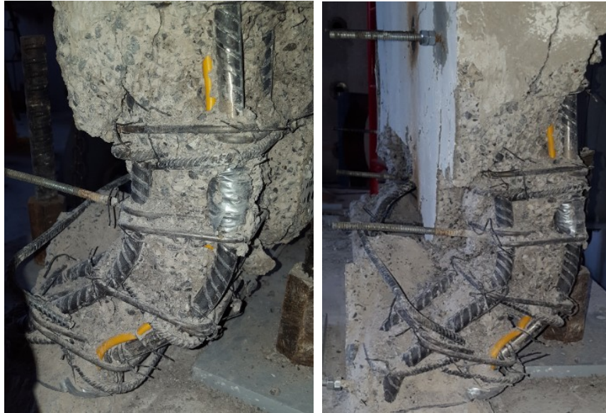
Figura 0.27: Pandeo fuera del plano, una vez finalizado el ensayo MR2.
