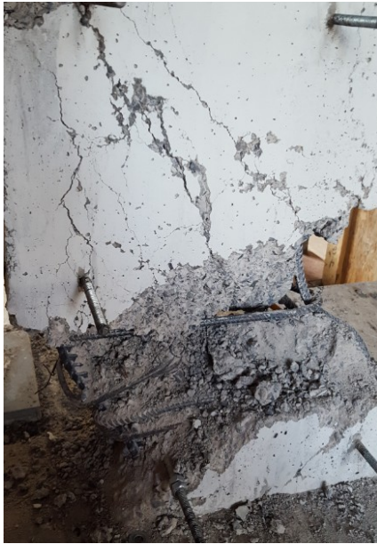
Figura 0.29: Estado probeta MR2 en la falla (1).
