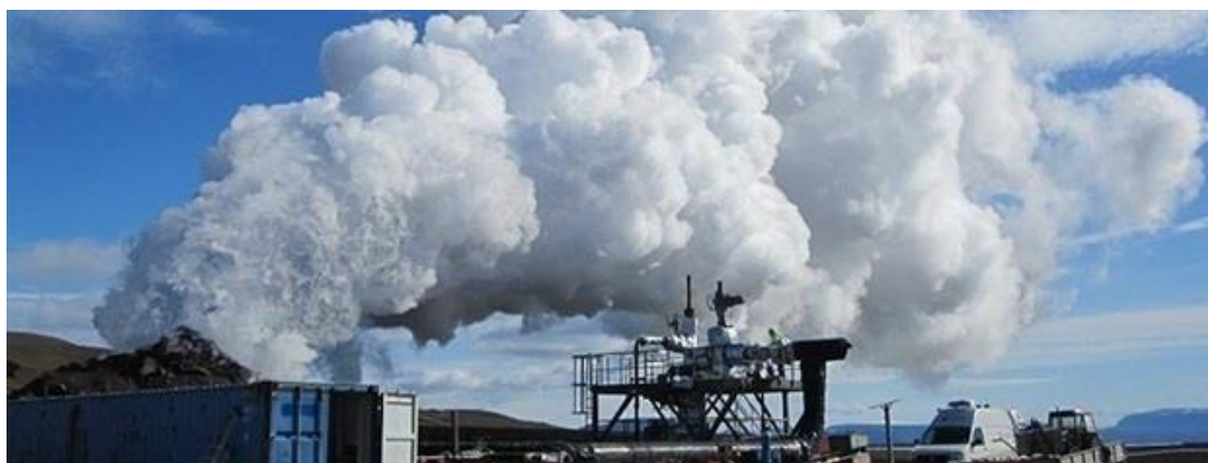
IMAGEN 8. POZO GEOTÉRMICO IDDI-1, ISLANDIA. FUENTE: LA TERCERA.
