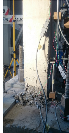
(b) Daño al 3 % en zona traccionada para carga lateral negativa.
