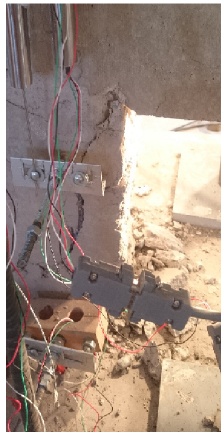
(b) Daño al 3 %, lado discontinuo.
