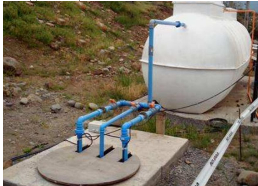
Imagen 83: conexión de bombas elevadoras a estanque principal. Fuente: http://www.limwaters.cl/
