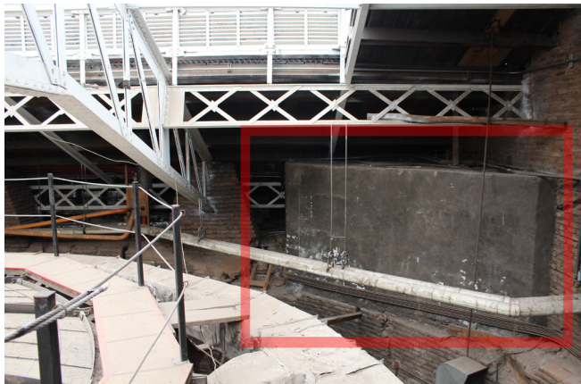
Fig. 173 Fotografía estanque de agua sobre Cámara de Senadores. Elaboración propia
