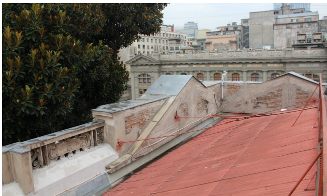
Fig. 174 Fotografía tensores en antetecho sector suroriental del Edificio. Elaboración propia
