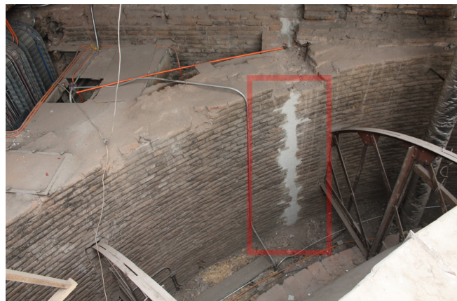
Fig. 164 Grieta vertical en muro hemisiclo Cámara de Senadores. Elaboración propia
