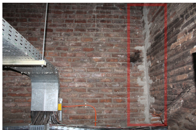
Fig. 165 Grieta pasante en esquina sector poniente entretecho. Elaboración propia
