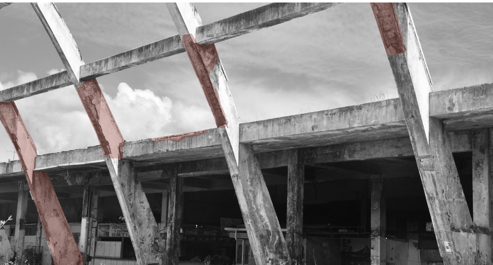
Imagen 24: Daños estructura / Fuente: Elaboración propia
