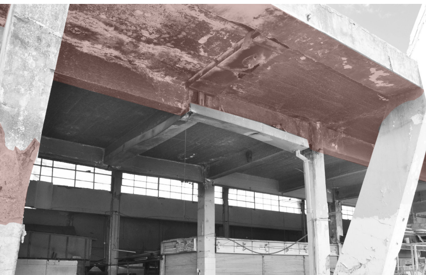
Imagen 26: Daños estructura / Fuente: Elaboración propia
