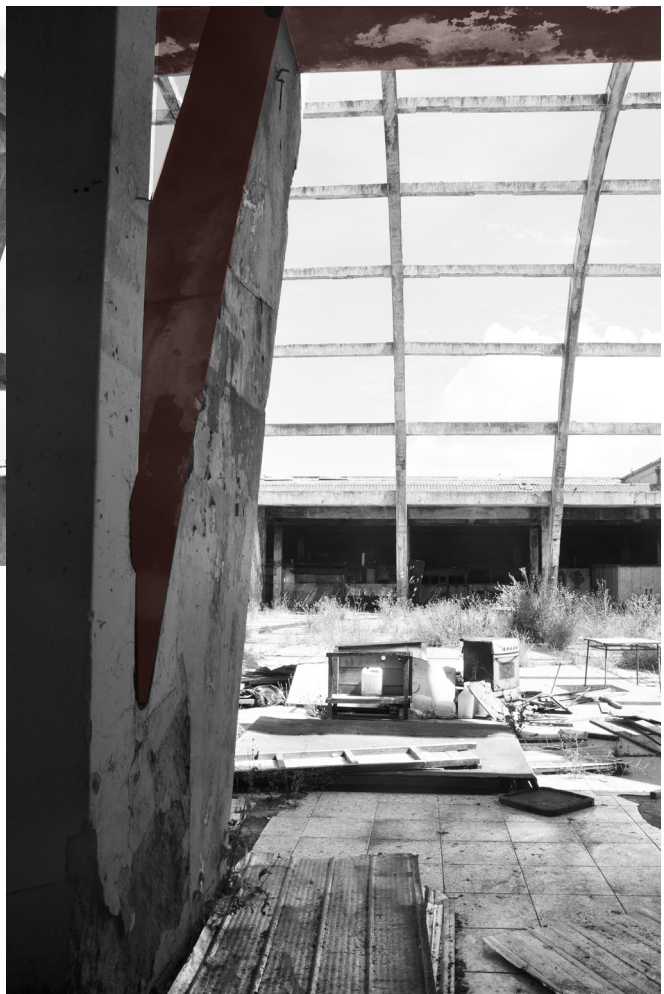
Imagen 23: Daños estructura / Fuente: Elaboración propia
