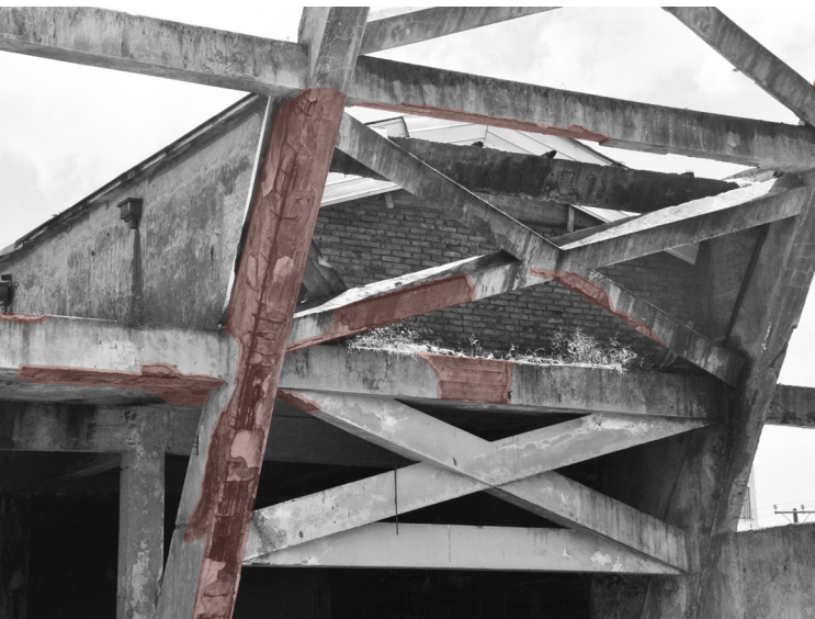
Imagen 22: Daños estructura / Fuente: Elaboración propia
