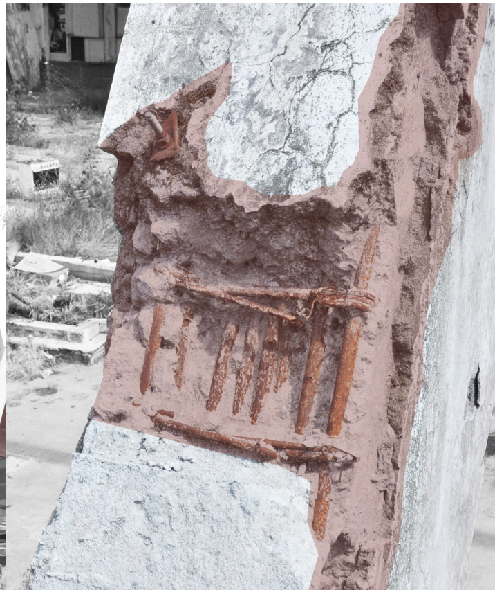
Imagen 27: Daños estructura / Fuente: Elaboración propia
