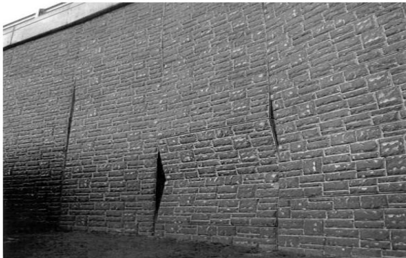
Figura 2.19 Dislocación entre paneles de Hormigón, Neely and Tan (2010).
