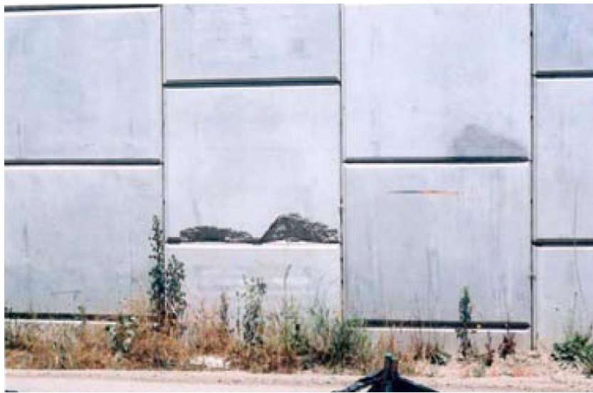
Figura 2.20 Agrietamiento entre paneles de Hormigón, Neely and Tan (2010).
