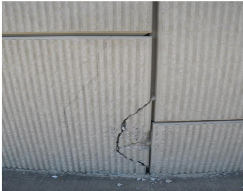
Figura 2.14 Agrietamiento de paneles, Schmidt et al. (2011).
