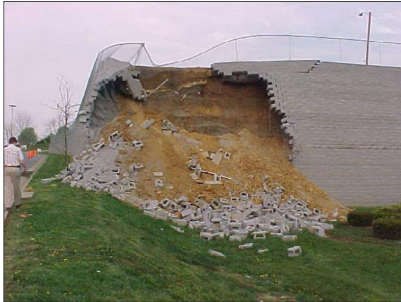
Figura 2.18 Colapso muro mecánicamente estabilizado en Virginia, Scarborough (2005).
