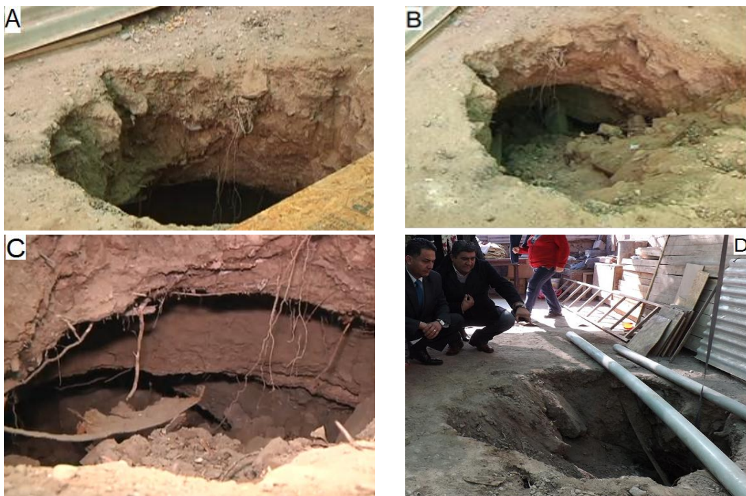
Figura 6. Imágenes de la subsistencia en patio de una casa, calle Manuel Montt 445 b, comuna de Tierra Amarilla. Posee un diámetro de 1,5 m y con 4 m de profundidad.
