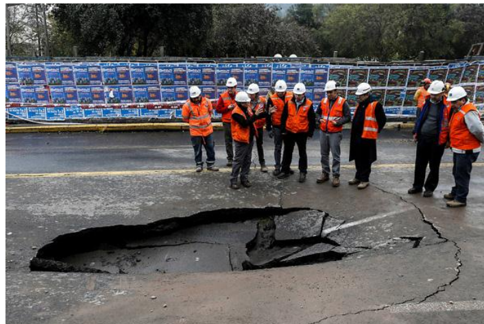
Figura 32. Subsistencia en Av. Providencia asociado a rotura de matriz de agua potable. Fuente: Marín (2016).
