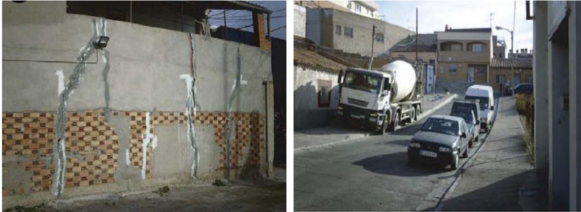
Figura 38. Imágenes de grietas prominentes en un edificio situado junto a la carretera N - 232 y hundimiento en una calle de Valdefierro en la ciudad de Zaragoza (GALVE et al. , 2009).
