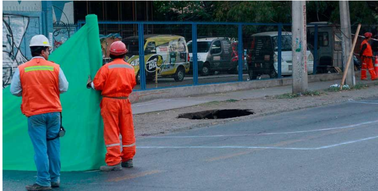
Figura 31. Subsistencia en Av. Independencia asociado a la construcción de la línea 3 del Metro de Santiago. Fuente: Nuñez (2016).
