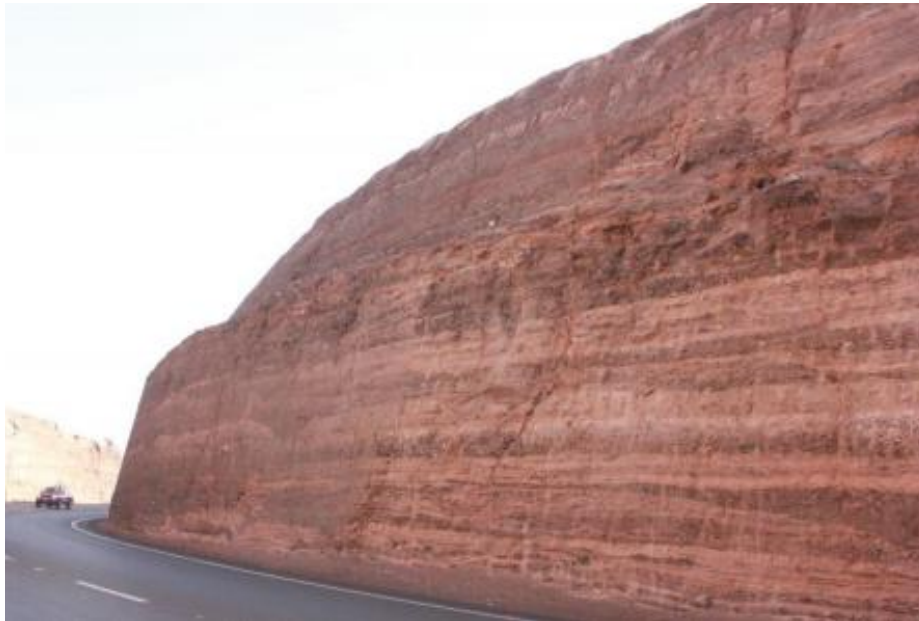
Figura 41. Imágenes de las gravas de Alto Hospicio en vía que conecta Iquique con Alto Hospicio (Ruta 16) en el Norte de Chile. Se observa la alternancia de niveles de gravas gruesas y materiales finos muy bien laminados con numerosas grietas rellenas de depósitos finos y/o materiales salinos SERNAGEOMIN (2014).
