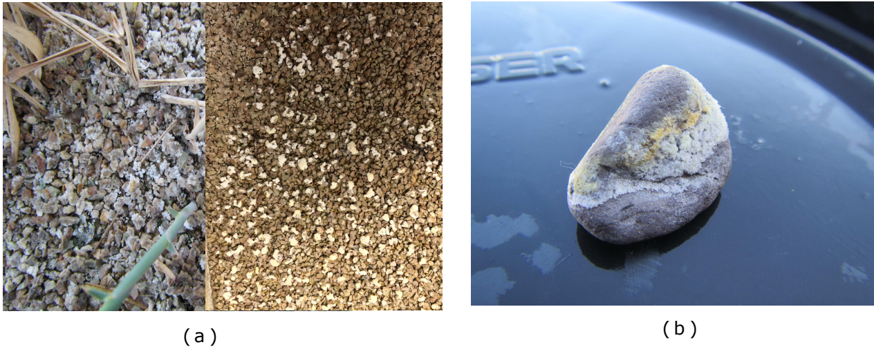
Figura 4.22: Formación de precipitados blancos. a) Zona intermedia del humedal vista en planta. b) Grava
