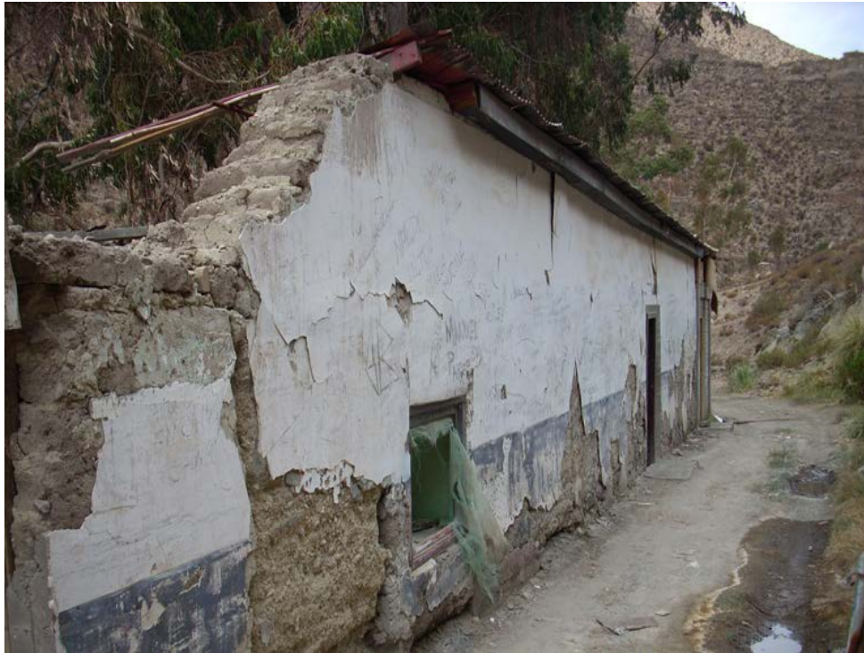
Fotografía 2: Restos de los baños antiguos, frente al socavón, y que se aprecian muy deteriorados por el terremoto de 2005. Fotografía del autor.
