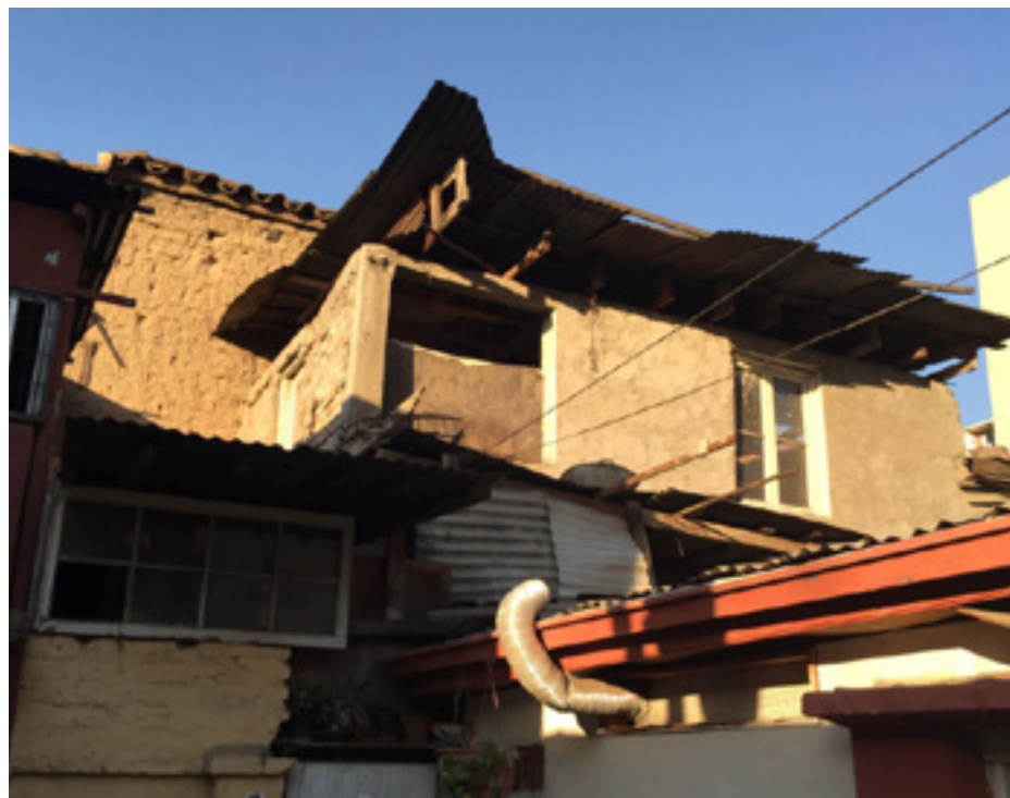
Vivienda en abandono en Cité Grajales 2496. Fuente: archivo fotográfico personal
