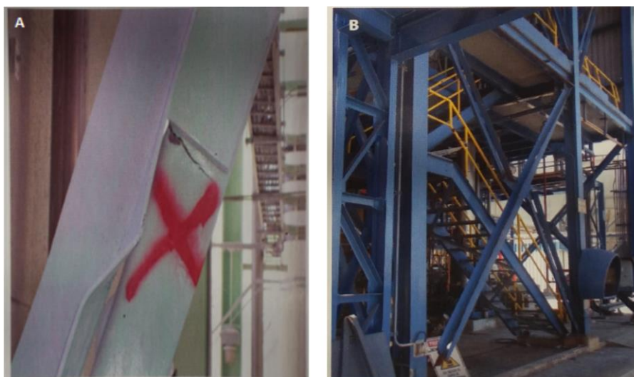
Figura 1.3: Fallas de perfiles XL producto del terremoto del Maule de 2010: (A) Pandeo local; (B) Falla de conexión por pandeo torsional; (Montecinos et al., 2012).
