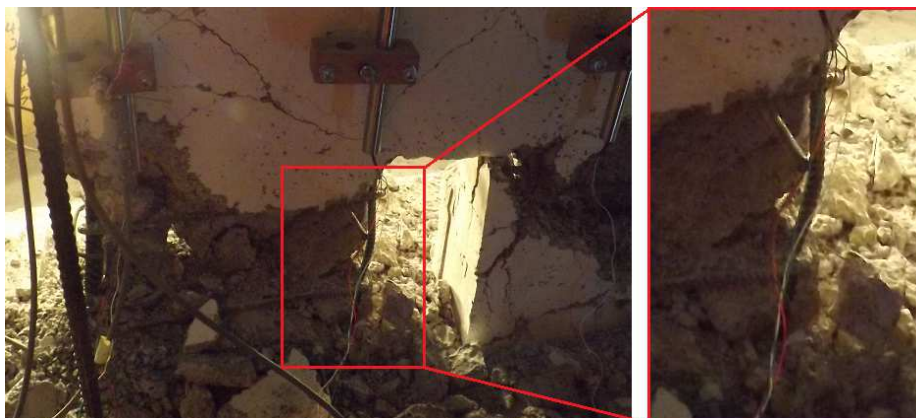
FIGURA 5.7 : PANDEO DE LA BARRA DE REFUERZO DE ABERTURA AL FIN DEL ENSAYO.
