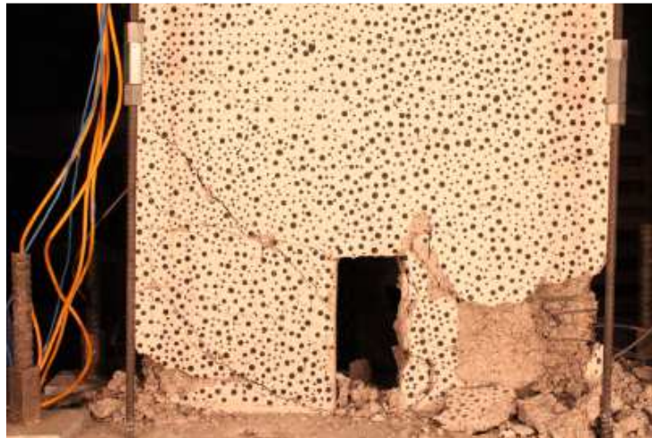
FIGURA 5.8: FALLA A COMPRESIÓN QUE GENERÓ LA PÉRDIDA DE CAPACIDAD.
