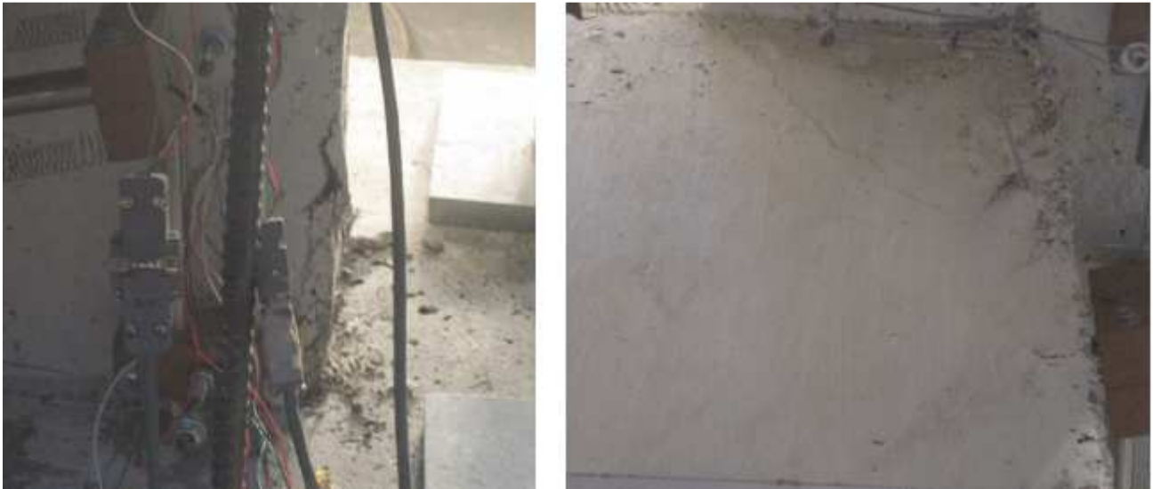
FIGURA 5.22: DESPRENDIMIENTO DEL HORMIGÓN (IZQUIERDA). GRIETA EN LOSA INFERIOR (DERECHA).
