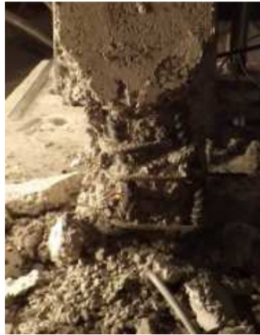
FIGURA 5.6 : PANDEO FUERA DEL PLANO YA OCURRIDA LA FALLA A COMPRESIÓN.
