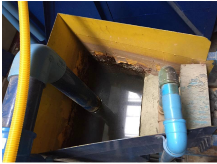
Figura 3.2: Tanque de entrada.
