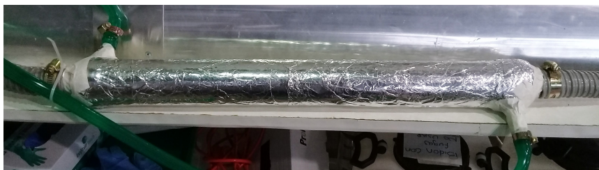
Figura 3.10: Intercambiador de calor.
