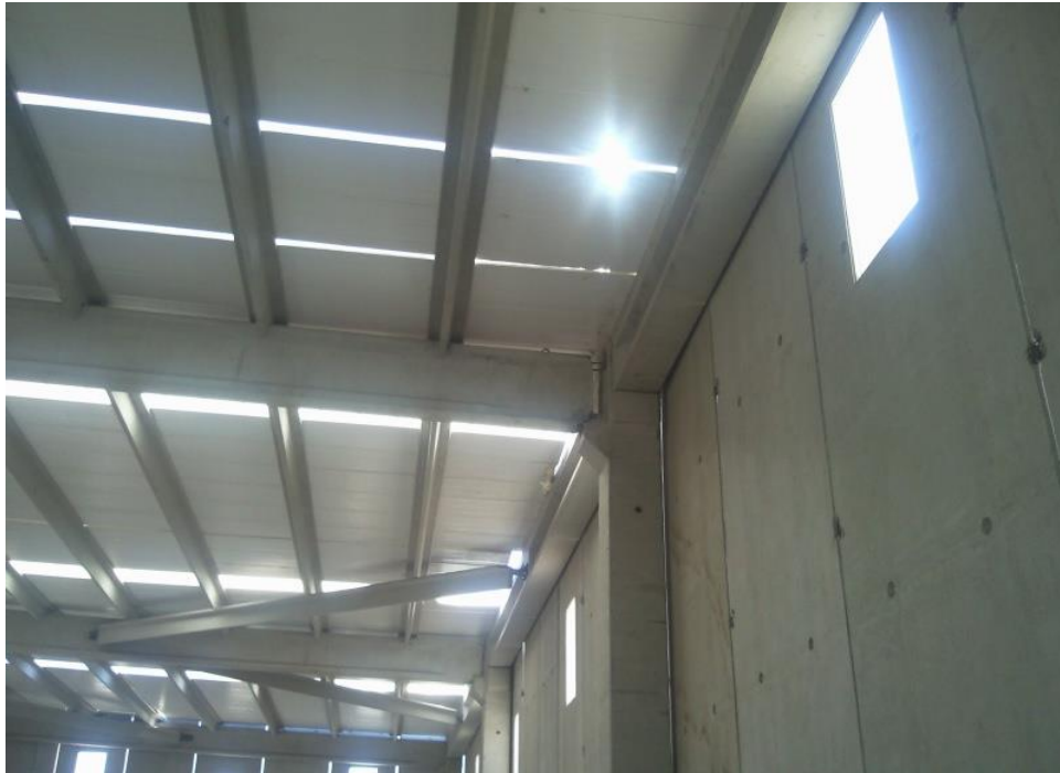
Figura 11 – Vista interior del galpón, posterior al terremoto del 27 de Febrero.
