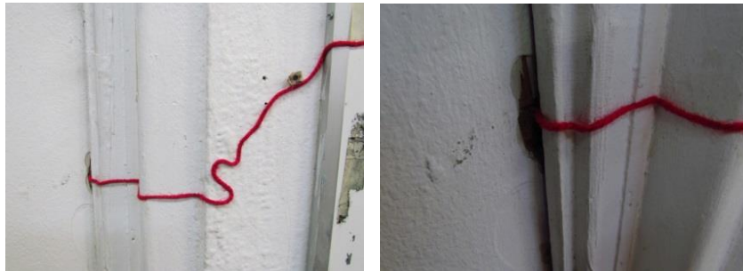
Lana adherida al muro
