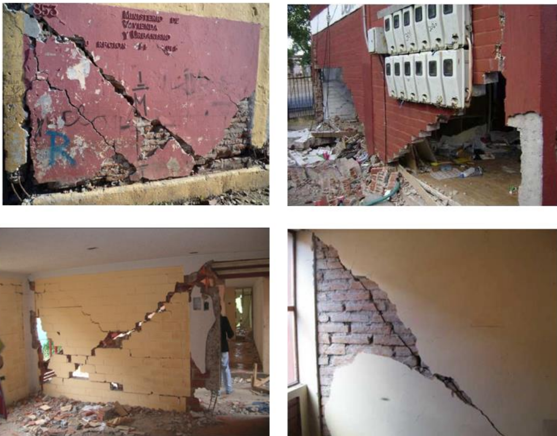
Figura N° 13. Ejemplos de fallas al corte en muros de albañilería (Castro, 2011).
