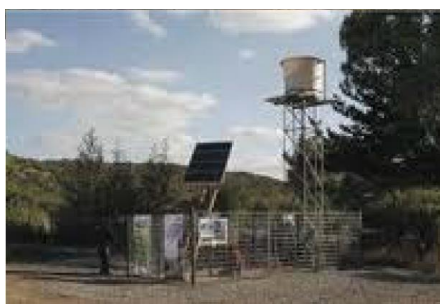
Figura 15: sistema de bombeo FV instalado en Illapel, IV Región, Chile. Fuente: CNR.
