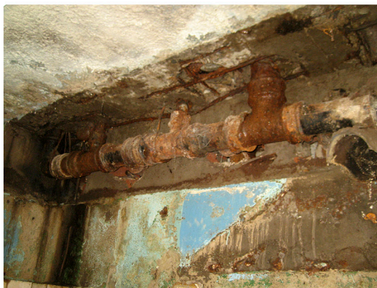
Fig. 58: Deterioro en Condominio Vestex
