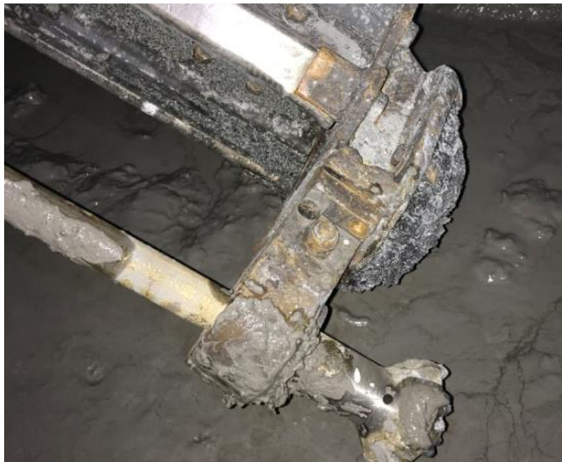
Figura 6-7 Tope de goma en malas condiciones.
