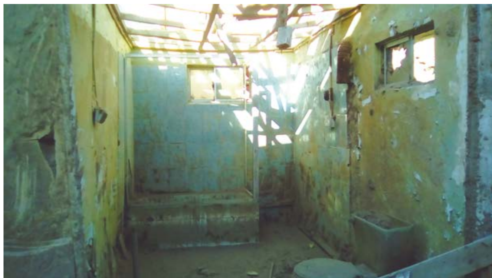
Figura 5. Fotografía que muestra daños en viviendas de Chañaral.
