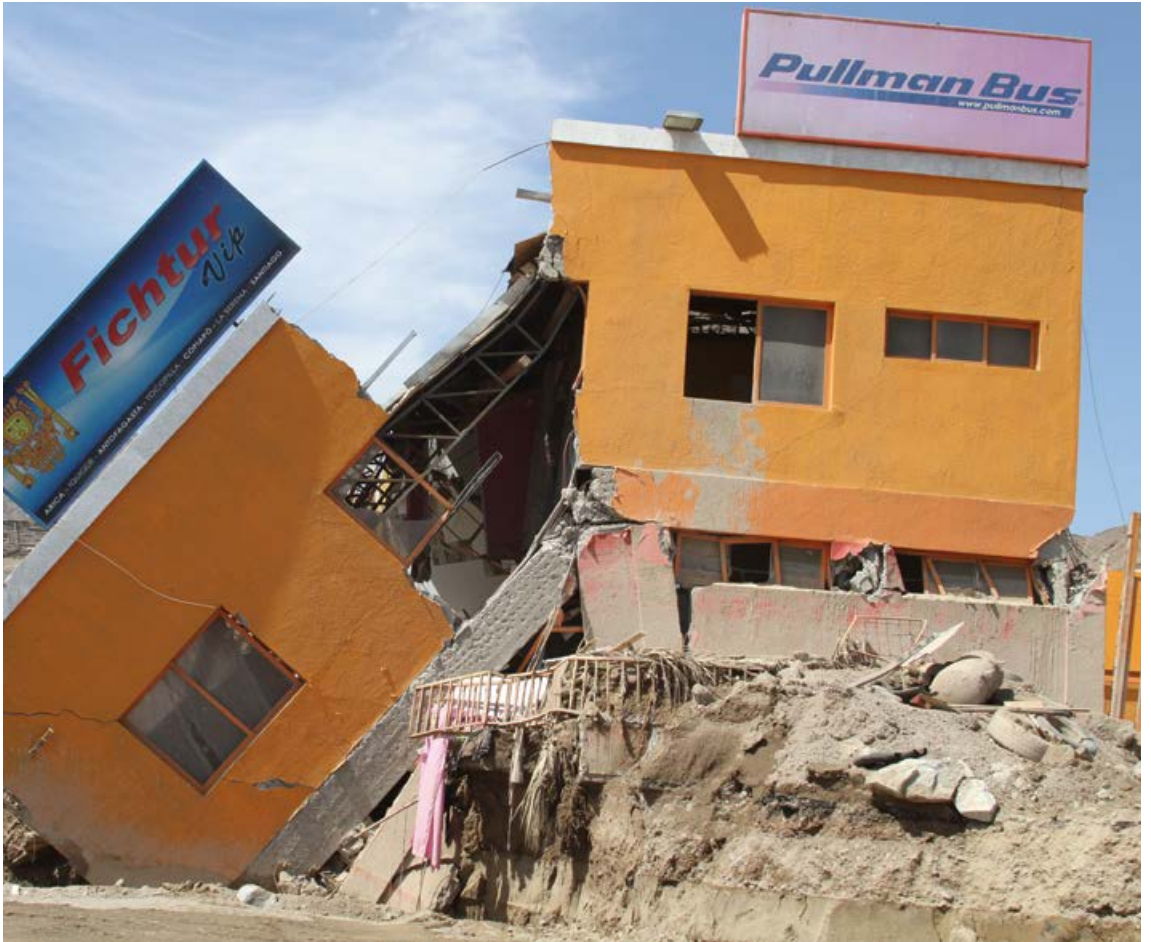
Fotografía tomada el 30 de marzo desde la costanera. Evidencia la dimensión de la destrucción por el impacto del aluvión, que socavó los cimientos de algunas edificaciones.
