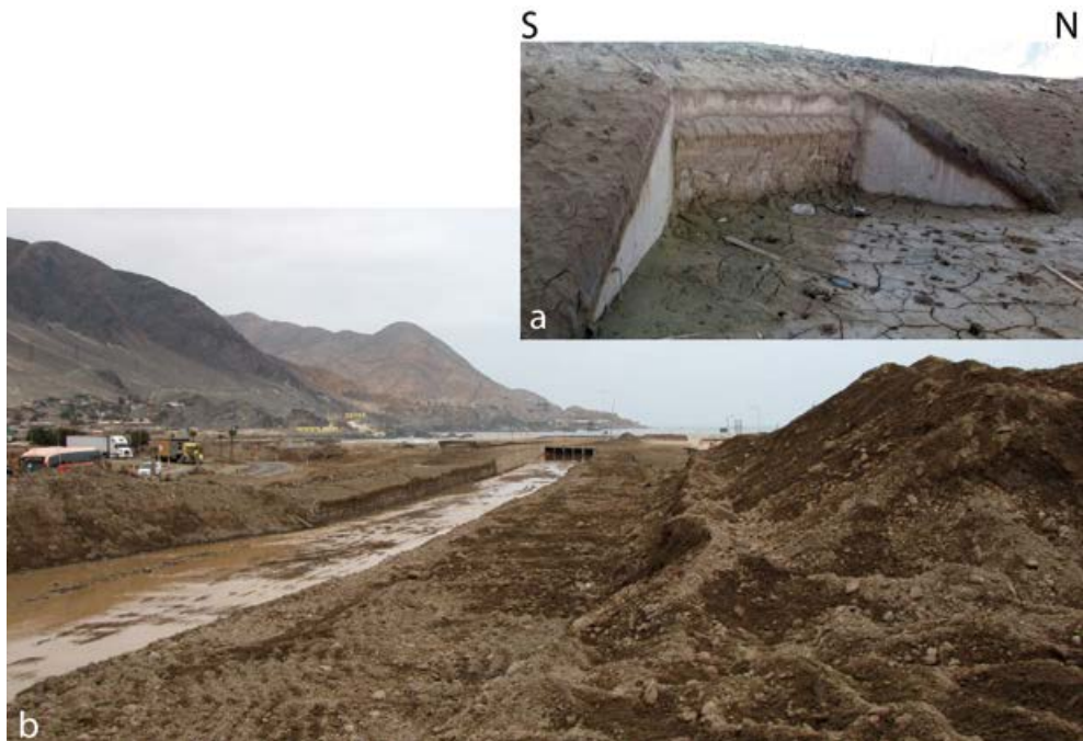
Figura 3. Vista de la canalización de la quebrada del río Salado bajo la Carretera Panamericana, con desagües colmatados por sedimento (a) Fuente: Gentileza de Cristián Cerda , y el canal ya limpiado luego de haber extraído gran cantidad de sedimentos luego del aluvión del 25 de marzo de 2015 (b) Fuente: Gabriel Easton .
