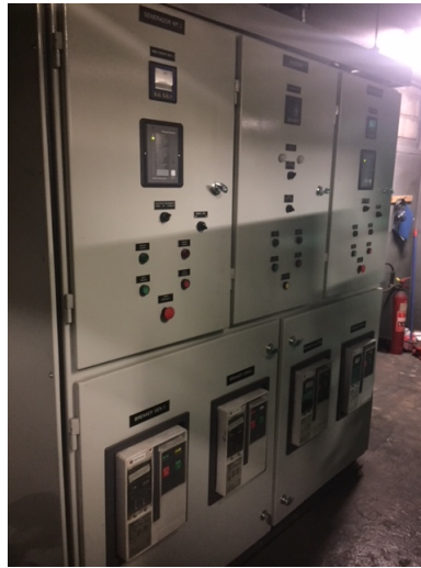
Figura 1.2: Foto del tablero de transferencia
