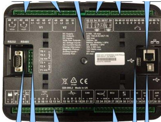
Figura 3.18: Vista por detrás del controlador modelo DSE8660 marca Deepsea donde se ven las diferentes interfases [29]
