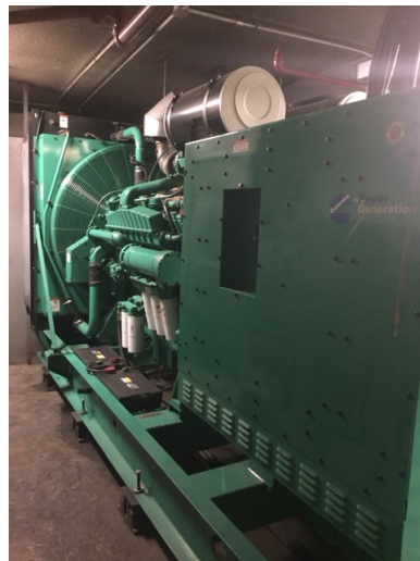
Figura 1.1: Foto de un grupo electrógeno
