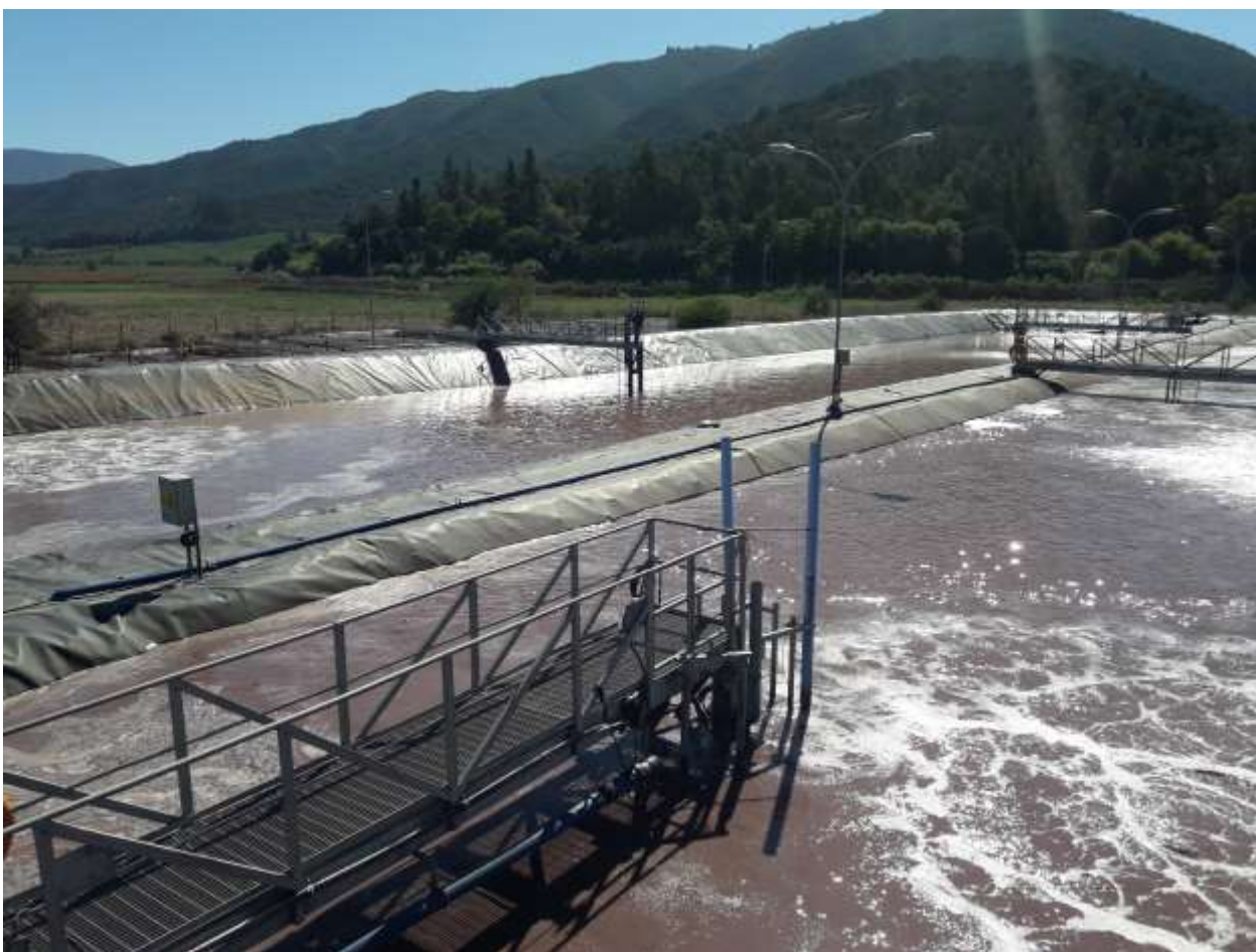
Figura 5-6: Tranques de acumulación de RIL en Bodega Cachapoal.
