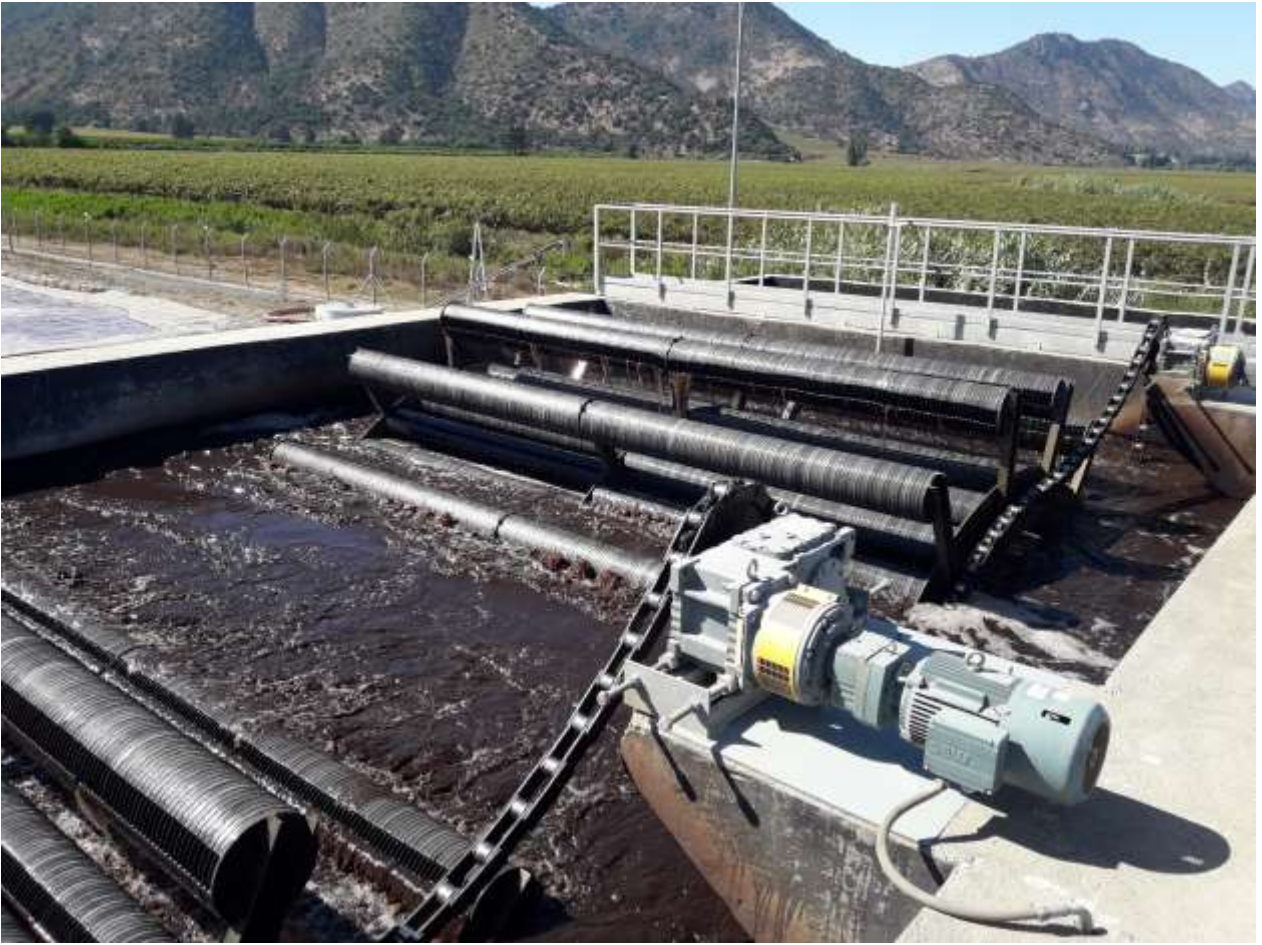
Figura 5-5: Reactor de lodos activados de Bodega Cachapoal.
