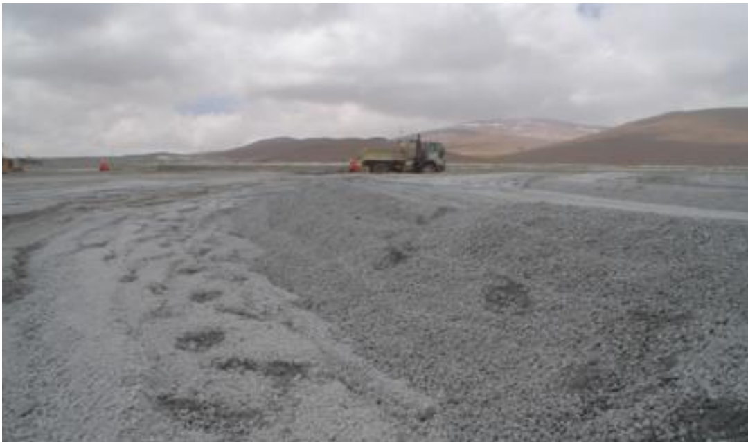
Figura 9: Superficie irregular generada durante la etapa de apilamiento.
