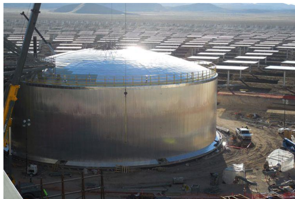
Figura 20: Estanque de almacenamiento térmico [16]
