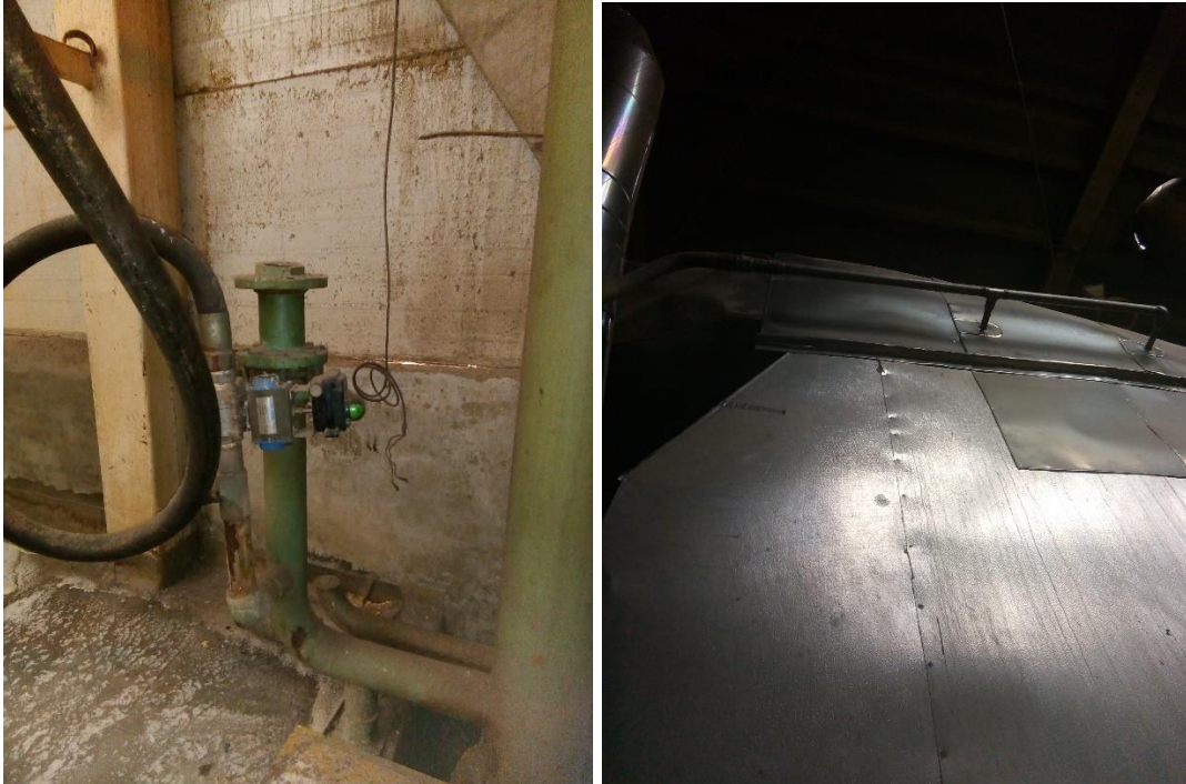
Figura 47: Conexión cortada a la válvula de agua industrial que alimenta al intercambiador de calor.
