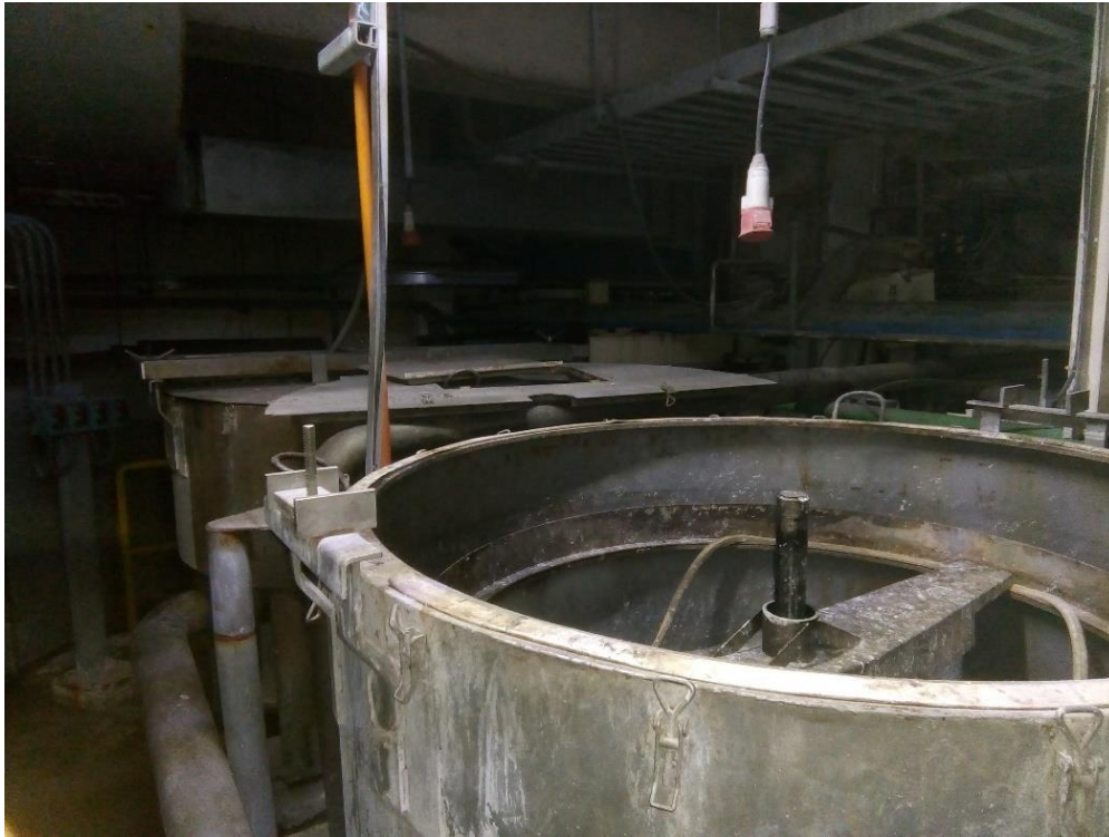
Figura 45: Imagen del filtro gravitacional FI-01, el cual se encuentra descuidado y sin la malla filtrante.
