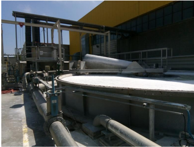
Figura 17: Parte del circuito de clarificación de aguas. A la izquierda se encuentra un fraccionador de fibras, mientras que a la derecha se encuentra el clarificador.
