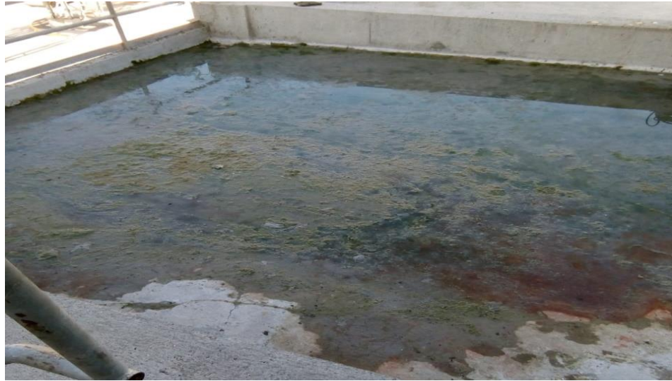
Figura 39: Presencia de algas en el rebalse de la torre de enfriamiento de la MP2, el cual utiliza agua de efluentes de manera directa en la configuración Atmos.
