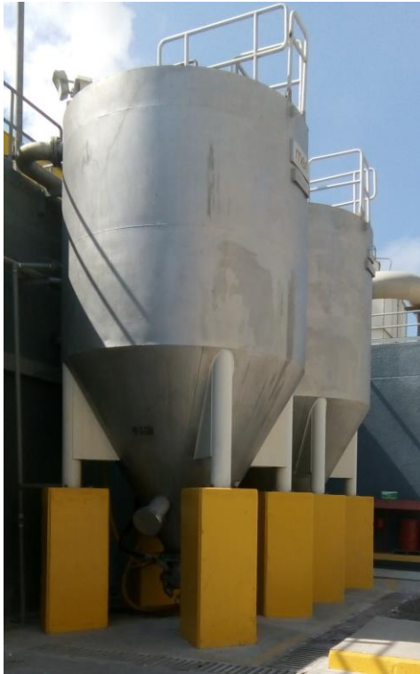
Figura 35: Filtros de arena (FA-335A y B) del circuito de clarificación de aguas de la MP2.
