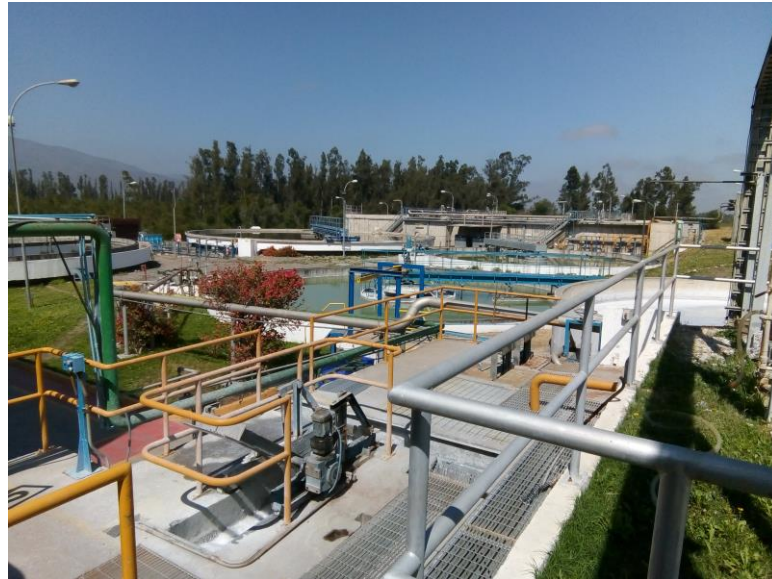
Figura 18: Planta de tratamiento de efluentes de CMPC Talagante.
