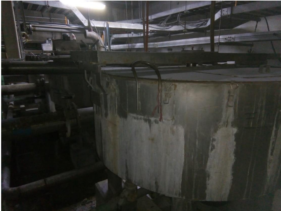
Figura 46: Imagen del filtro gravitacional FI-02, el cual se encuentra descuidado y sin la malla filtrante.
