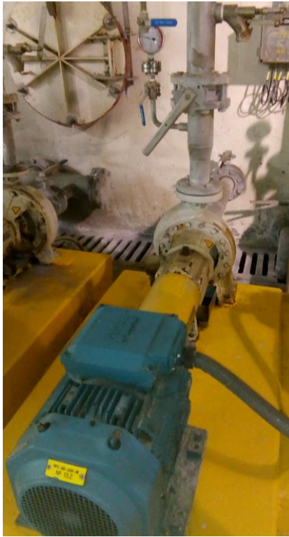
Figura 34: Bomba BB-335. Alimenta los filtros de arena con agua clarificada.
