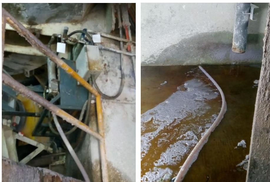
Figura 48: Intercambiador de calor y flujo de agua descargado a piso en Preparación Pasta 1.
