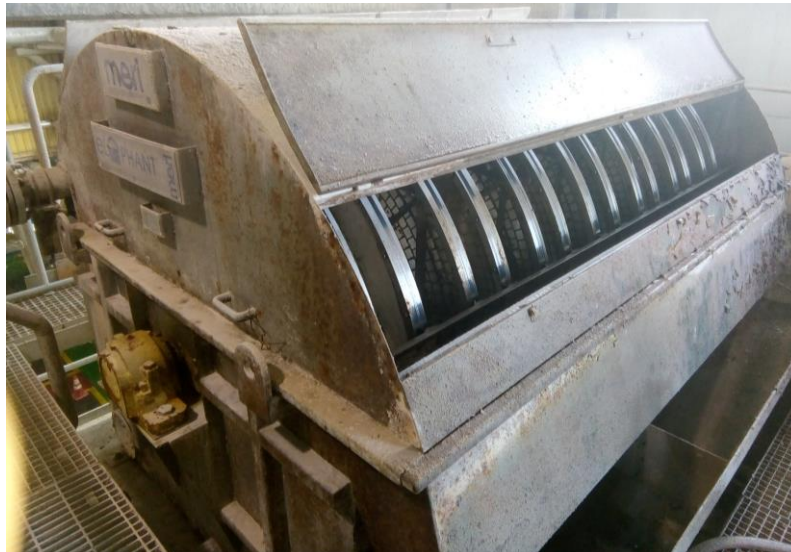
Figura 33: Espesador EE-324, el flujo de fibra gruesa ingresa al TQ-350 (Recortes), mientras que el agua con finos se dirige al TQ-326.
