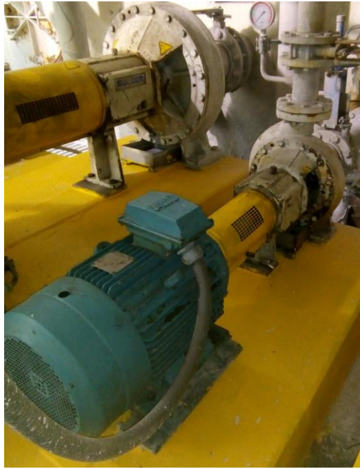
Figura 32: Bomba BB-325. Alimenta al espesador EE-324.
