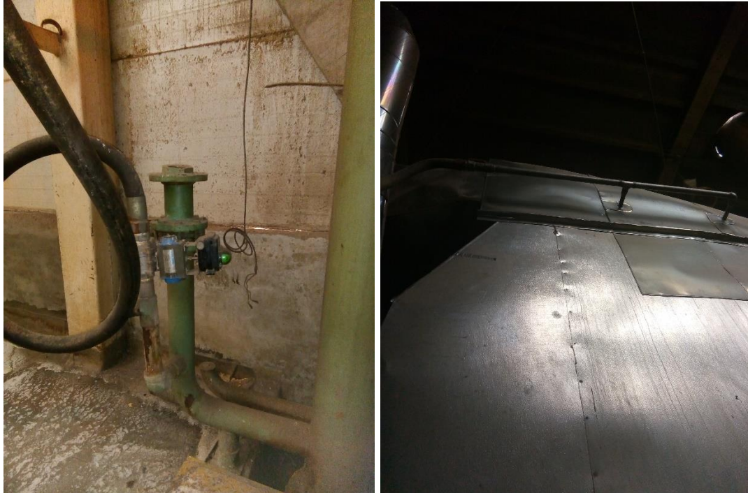
Figura 47: Conexión cortada a la válvula de agua industrial que alimenta al intercambiador de calor.
