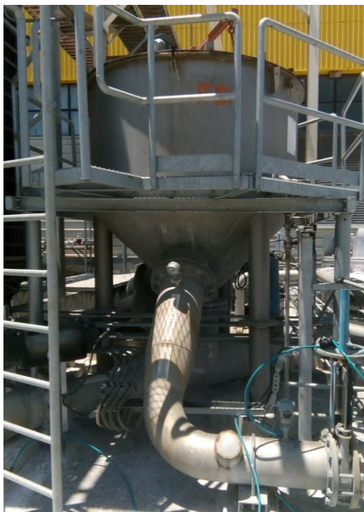
Figura 31: Fraccionador de fibras FF-324. La fracción de fibras gruesas va al TQ-325, el agua con finos al TQ-326.
