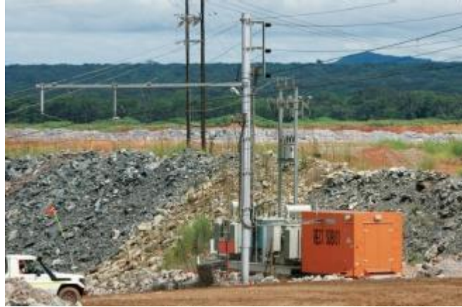
Ilustración 3: Subestaciones eléctricas sistema Trolley Assist
