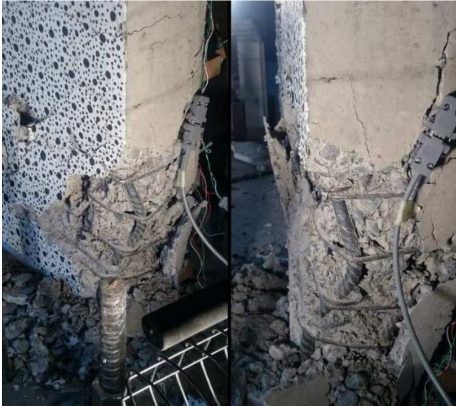
Figura 23: Desprendimiento del hormigón de recubrimiento y pandeo claro de barras del borde a compresión del muro base.
