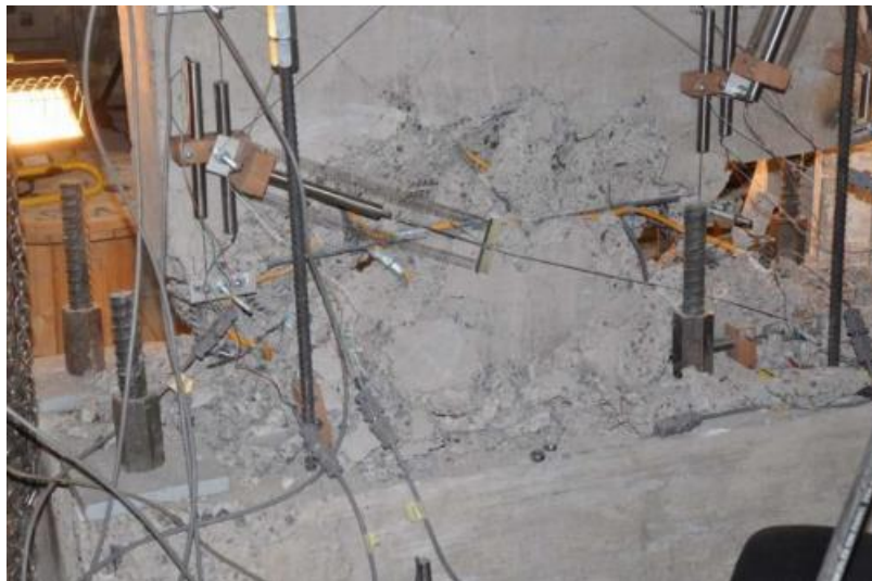
Figura 24: Condición del muro con abertura con daños concentrados en la base.
