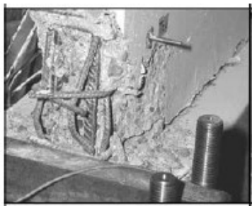
Figura 22: Patrón de falla para muros con refuerzo de mallas de alambre deformado en frío
