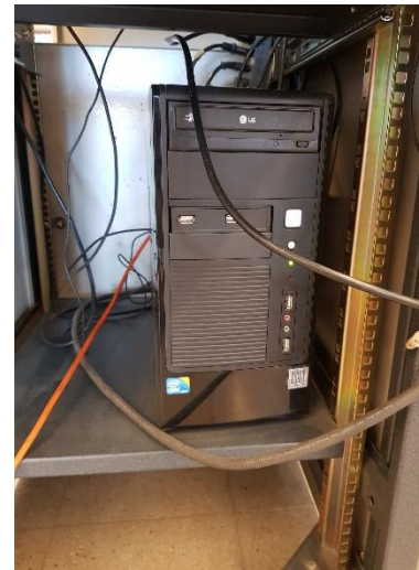
Figura 5.13. Computador Sistema en cual se encuentra la tarjeta de adquisición de datos.
